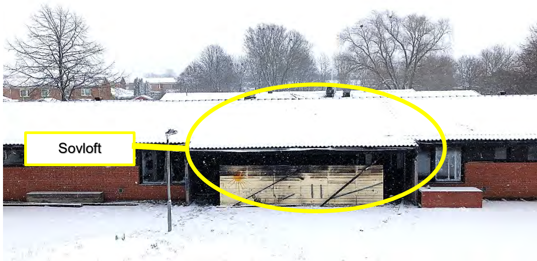
Bild: 2019-01-21. Västra fasaden på byggnaden. Brandskadorna är kraftigast i sovloftet.
