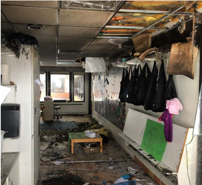
Figur 1. Bild: 2019-01-21. Kraftiga rökskador, men ingen brand i övriga verksamhetslokaler i västra byggnadskroppen.
