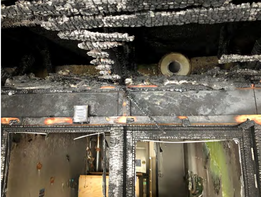
Bild: 2019-01-21. Vindsutrymme direkt ovanför sovloftet med kraftiga brandskador. På bilden syns också ventilationsrör dit brandgaser har kunnat ta sig in.
