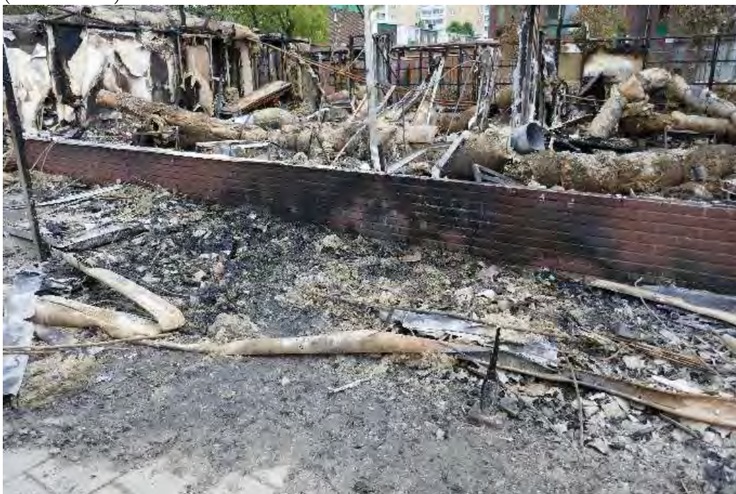
Foto 7. Enda stället på förskolan där det var sotbeläggning långt ner på fasadteglet.
