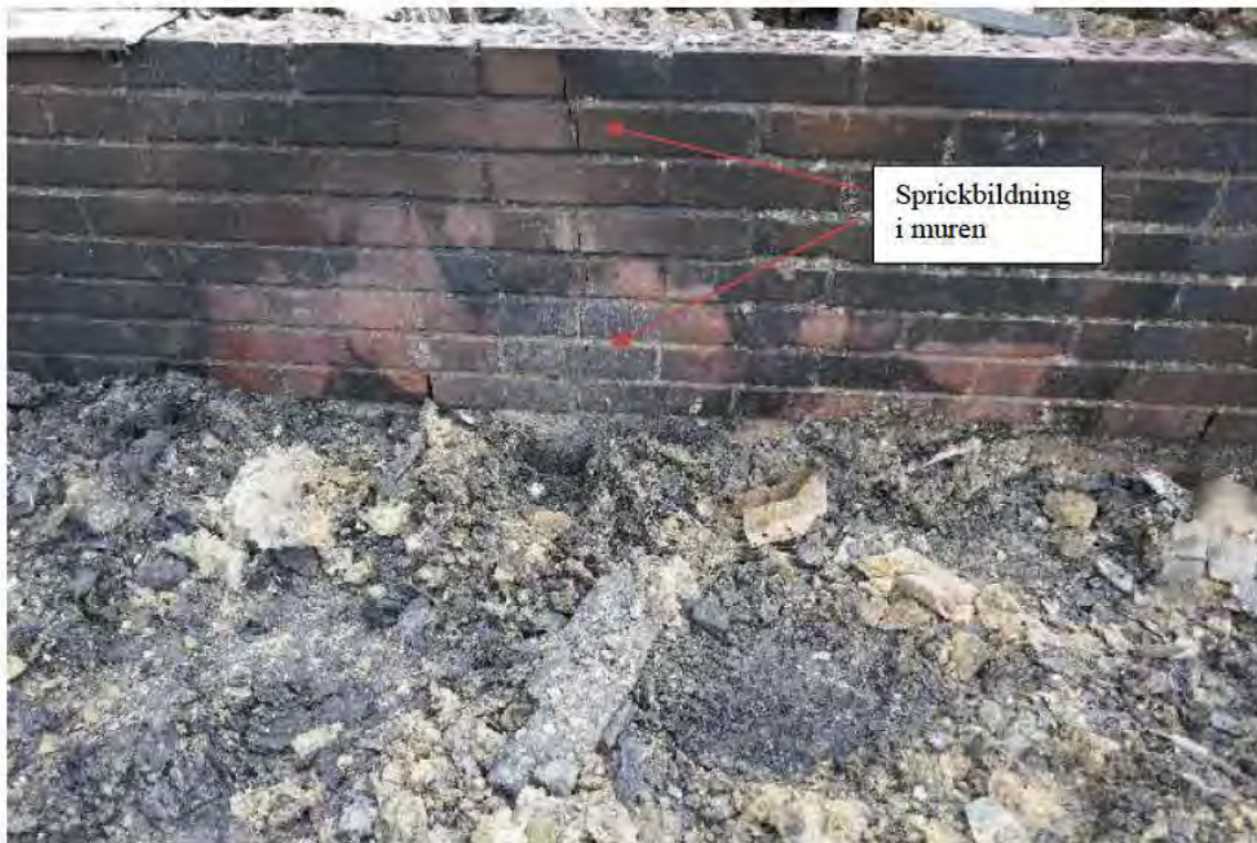
Foto 8. Enda stället som det fanns en sprickbildning i fasadteglet.
