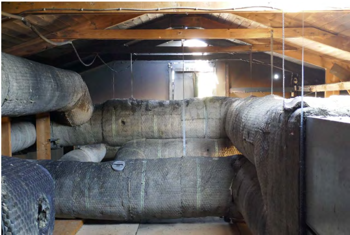
Foto 4 visar sotskador på vinden ovanför psykiatrimottagningen
