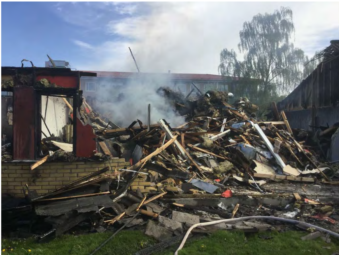
Foto 2 visar rester av byggnaden där skolan var inrymd samt väggen mot psykiatrimottagningen där byggnaden grävdes av för att hindra rökspridning
