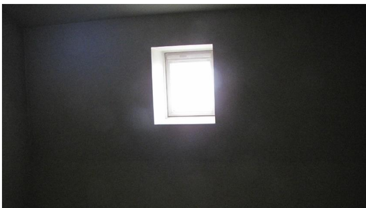
Foto 3. Rökluckan är placerad längst upp i trapphuset är ett öppningsbart fönster och det krävs en stege för att nå upp och öppna den.
