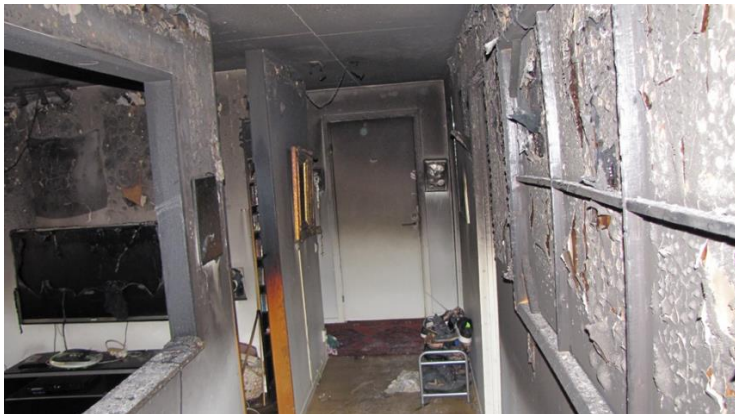
Foto 1: hallen med dess förlängning saknas det brandvarnare i taket.
