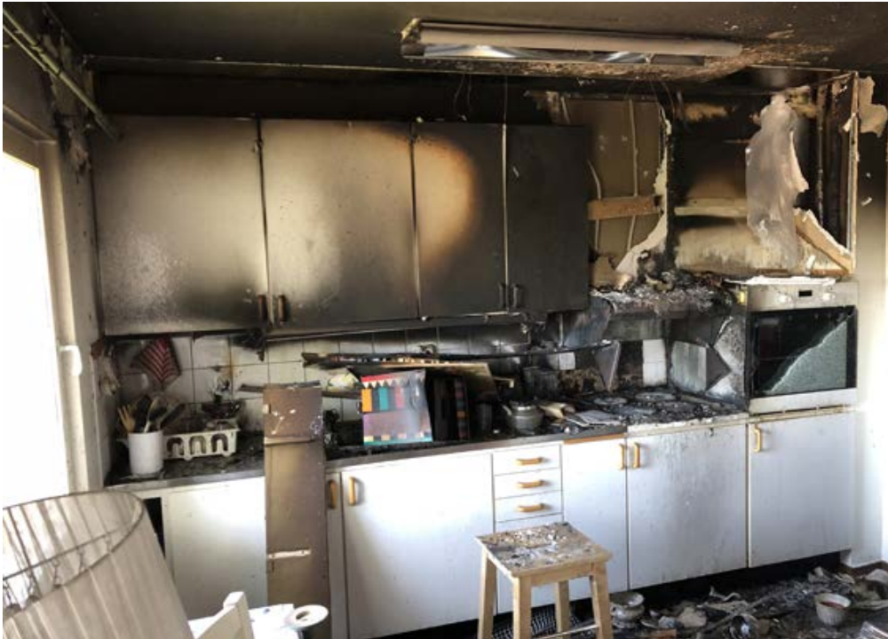
Köket har stora brand och rökskador
