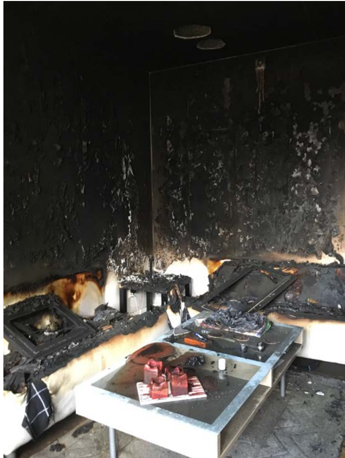
Väggarna i vardagsrummet var brandskadade över de båda sofforna.
