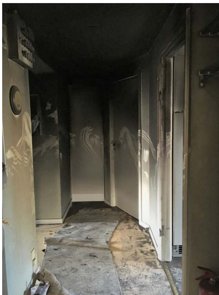
Samtliga rum i lägenheten var rök-och sotskadade.
