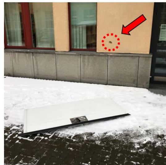
Bild 6. Visar vart baddörren slog i fasadväggen. Foto: Lärare i området.
