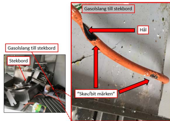
Bild 7. Visar vart gasolledningens placering efter explosionen samt berört hål samt skav alternativt bit märken. Foto RSG.
