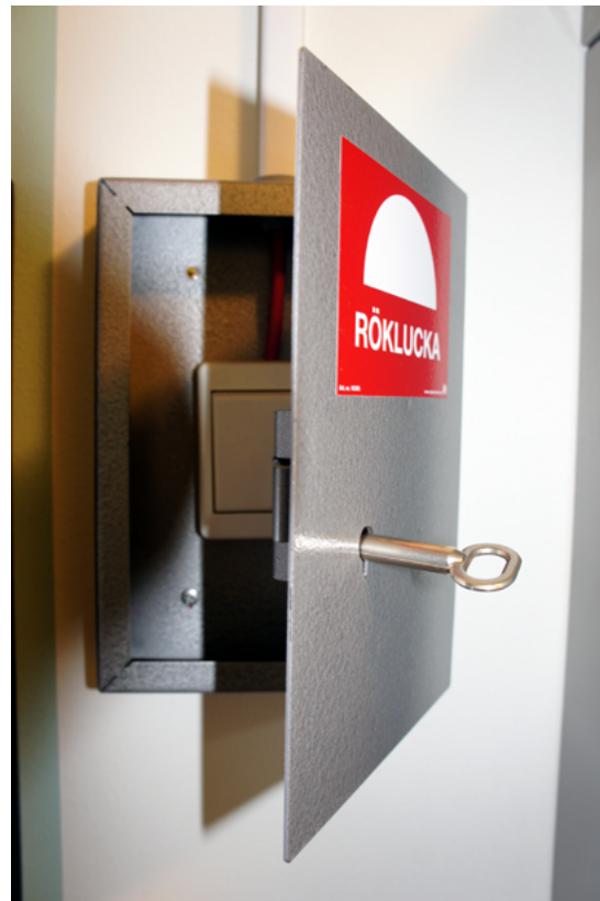
Vissa rökluckor kan öppnas med hjälp av en tryckknapp. Öppningsanordningen är oftast placerad vid entrén. Foto: MSB
