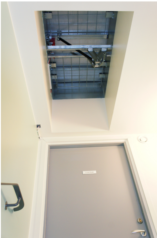
I taket syns en uppåtgående röklucka. Rökluckor används för att vädra ut brandrök. Se till att rökluckorna provas och servas regelbundet, förslagsvis årligen. Foto: MSB
