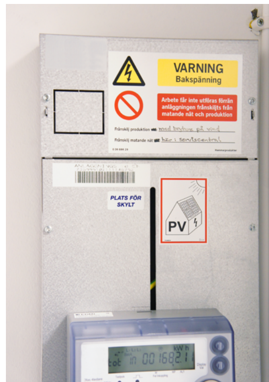
En solcellsanläggning ska förses med de varningsskyltar och den märkning som krävs. Foto: MSB
