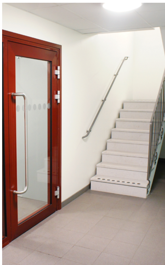
Håll trapphuset fritt från brännbara föremål och sådant som kan hindra vid utrymning. Foto: MSB
