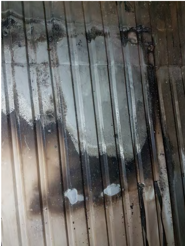
Figur 1. All sot är bortbränd från väggen.
