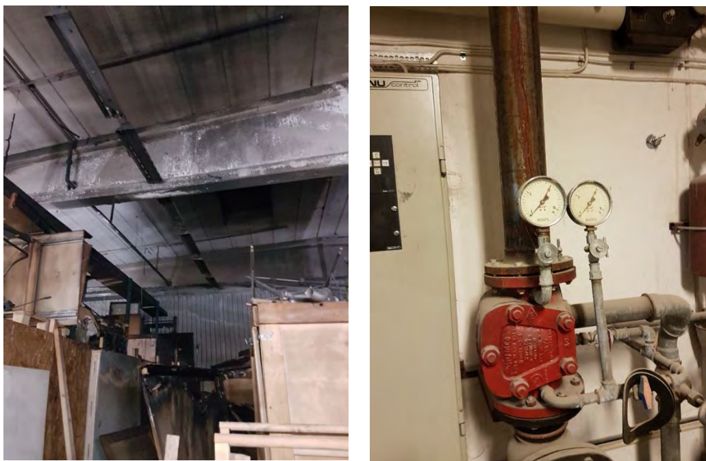
Figur 6. Sprinklerrör i lokalen tv. Sprinklercentral th.
