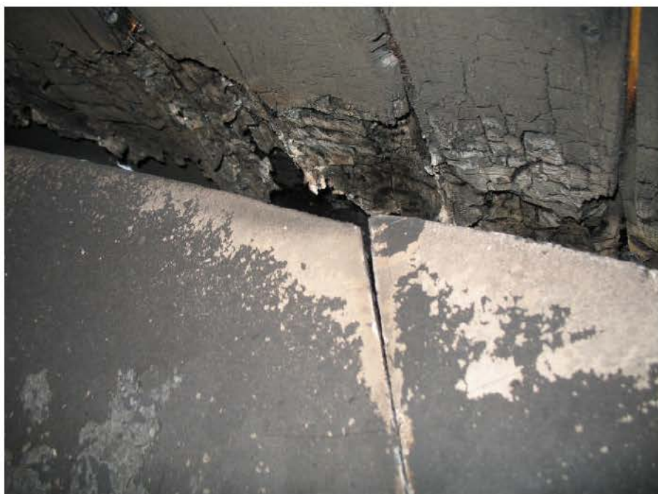
Bild 7. Brandspridningen förbi brandcellsgränsen hus A (3).
