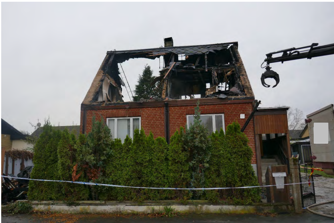
Foto 1. Kraftiga brandskador på byggnaden.
