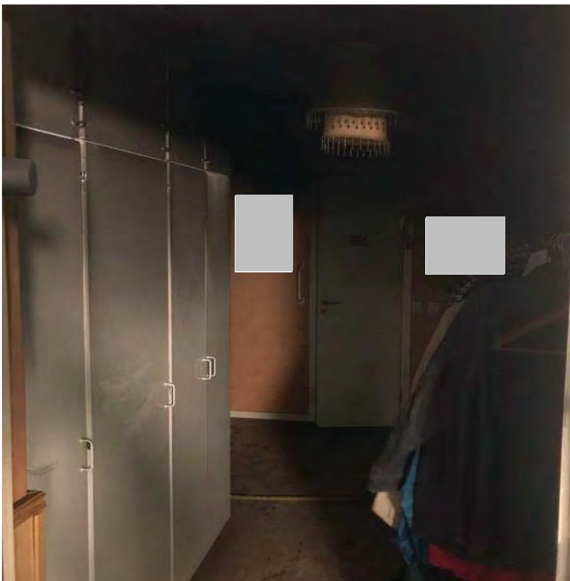
Figur 4 Röskador i hall
