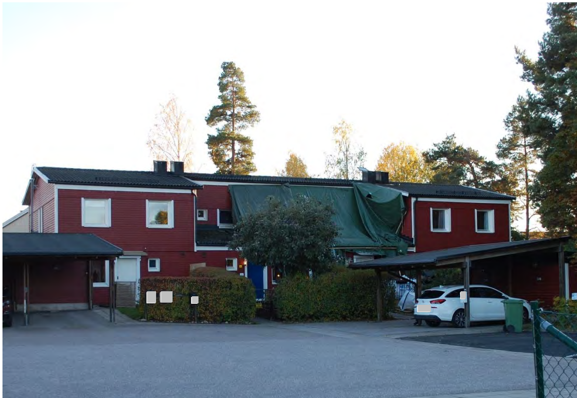
Bild SSBF. Under presenningen finns det utrymme som värmepumpen var placerad i.
