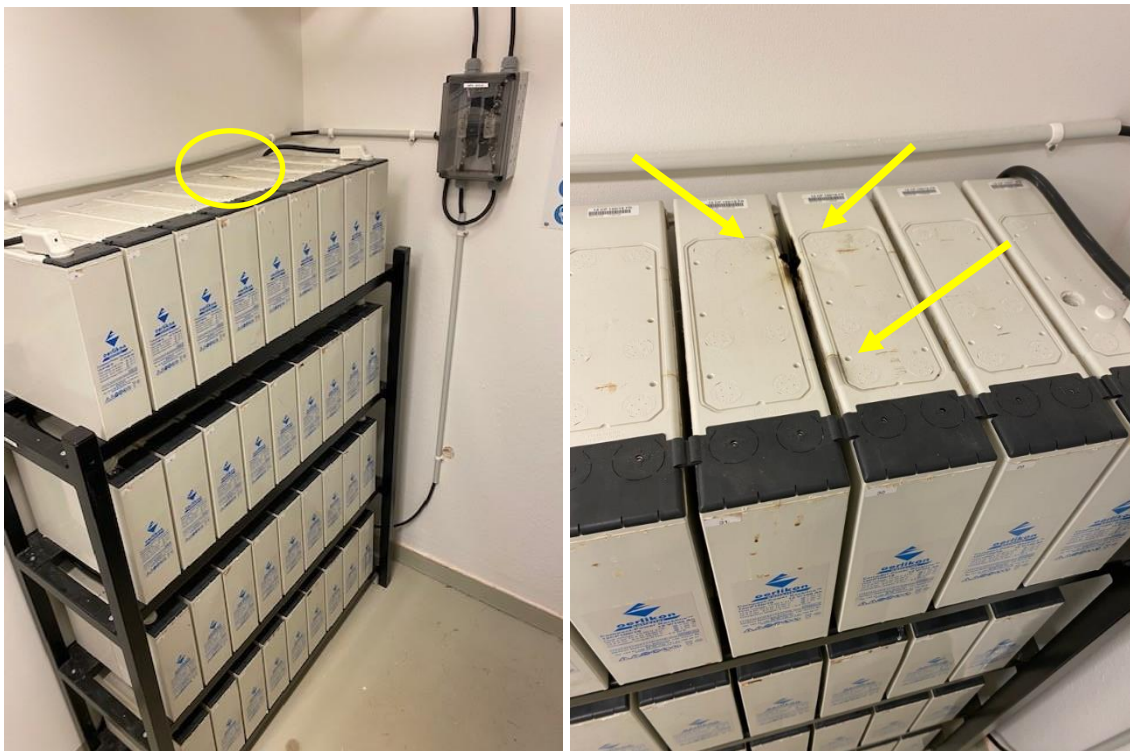
Bild. Batterier som rusat. Yttre tecken på rusning synliga på översta raden.
