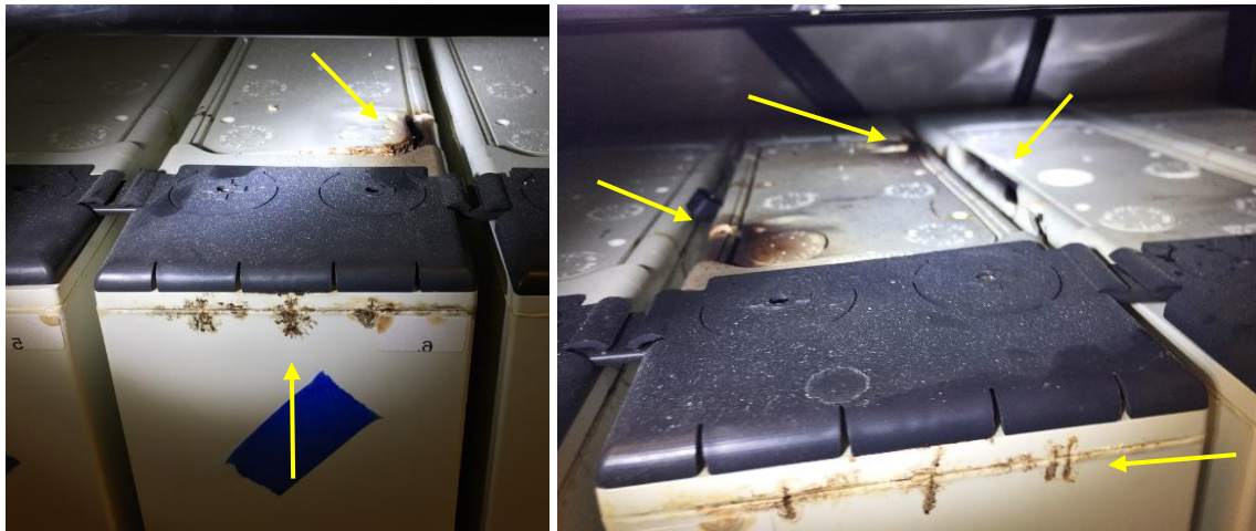
Bild. Tecken på rusning/brand i tre av anläggningens batterier markerade.
