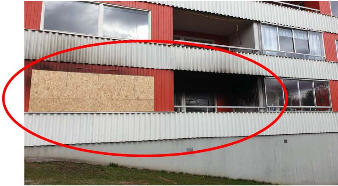
Fönster till vardagsrummet samt sovrummet (Bilden är tagen när saneringsfirman påbörjat saneringsarbetet)
