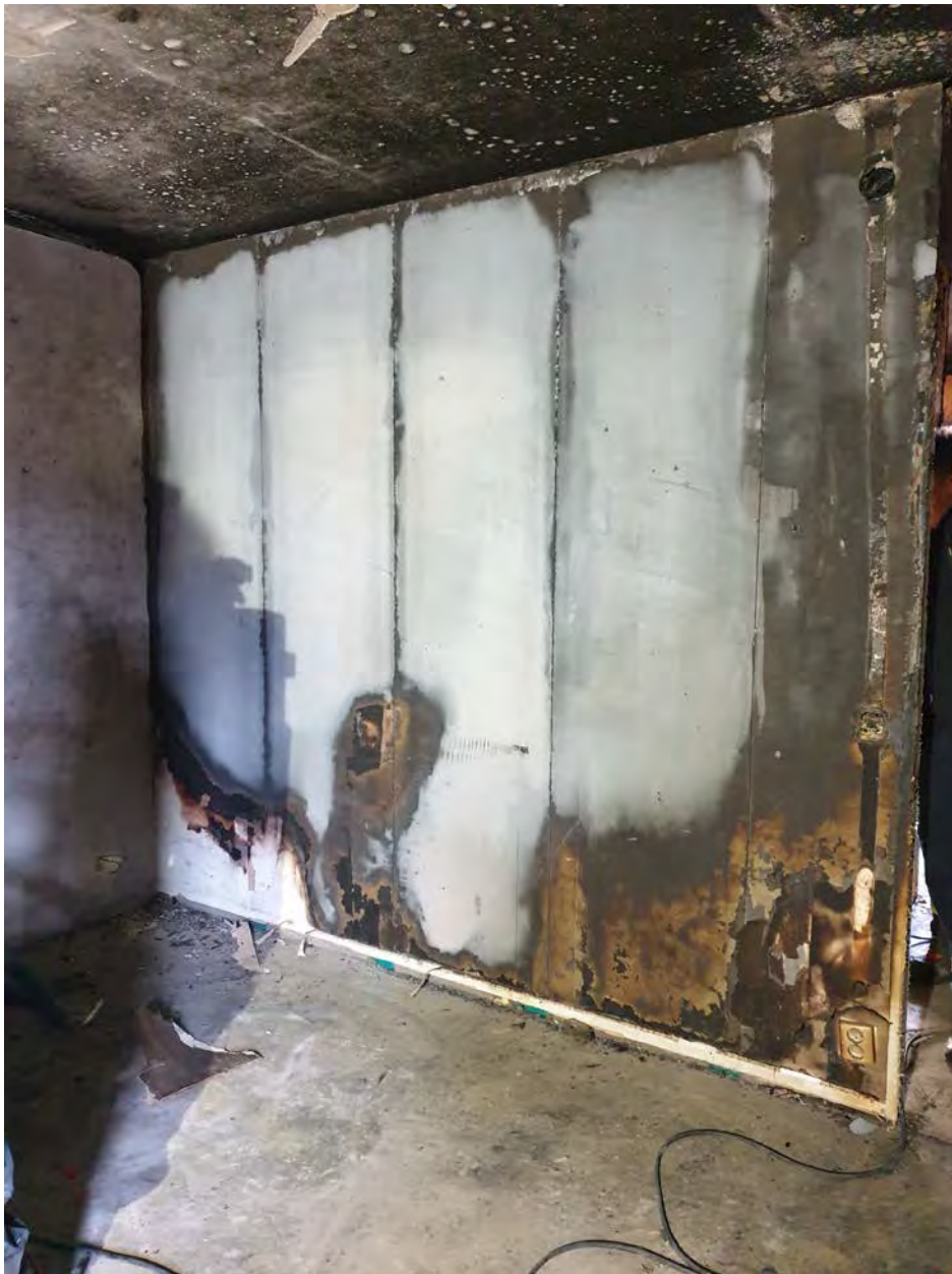
Väggen där branden startade. (Bilden är tagen när saneringsfirman påbörjat saneringsarbetet)
