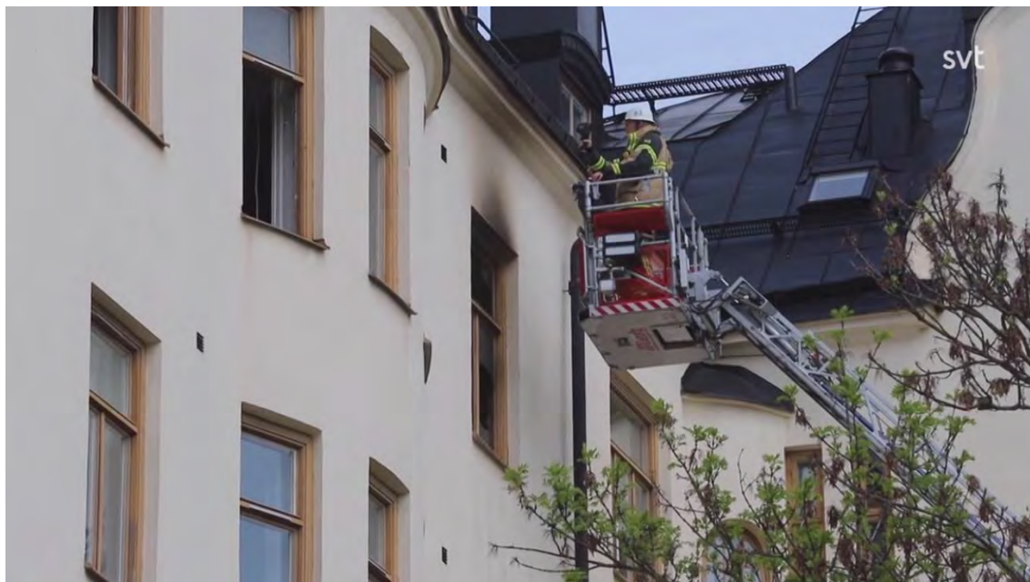
Bild SVT Nyheter. Brandlägenhet med synliga sotavlagringar på fasad och takfot ovanför fönster.
