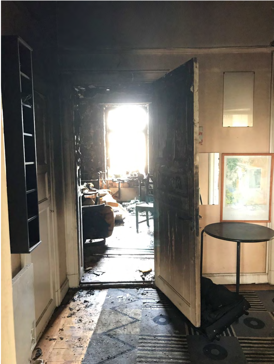
Bild SSBF. Dörr till brandlägenheten tagen från hallen. Tydligt tecken på hur brandrumsdörren (som var i stängt läge) har fördröjt brandspridning till hallen.
