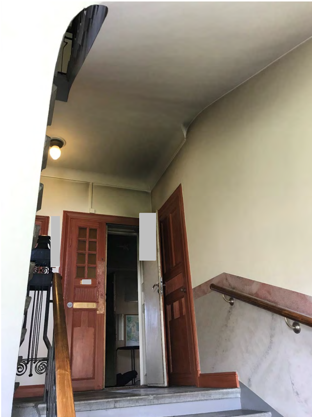
Bild SSBF. Brandlägenhet från trapphuset med soavlagrimgar i taket. Tecken på hög värmeutveckling i taket till hallen synlig på den öppna dörrens ovansida.
