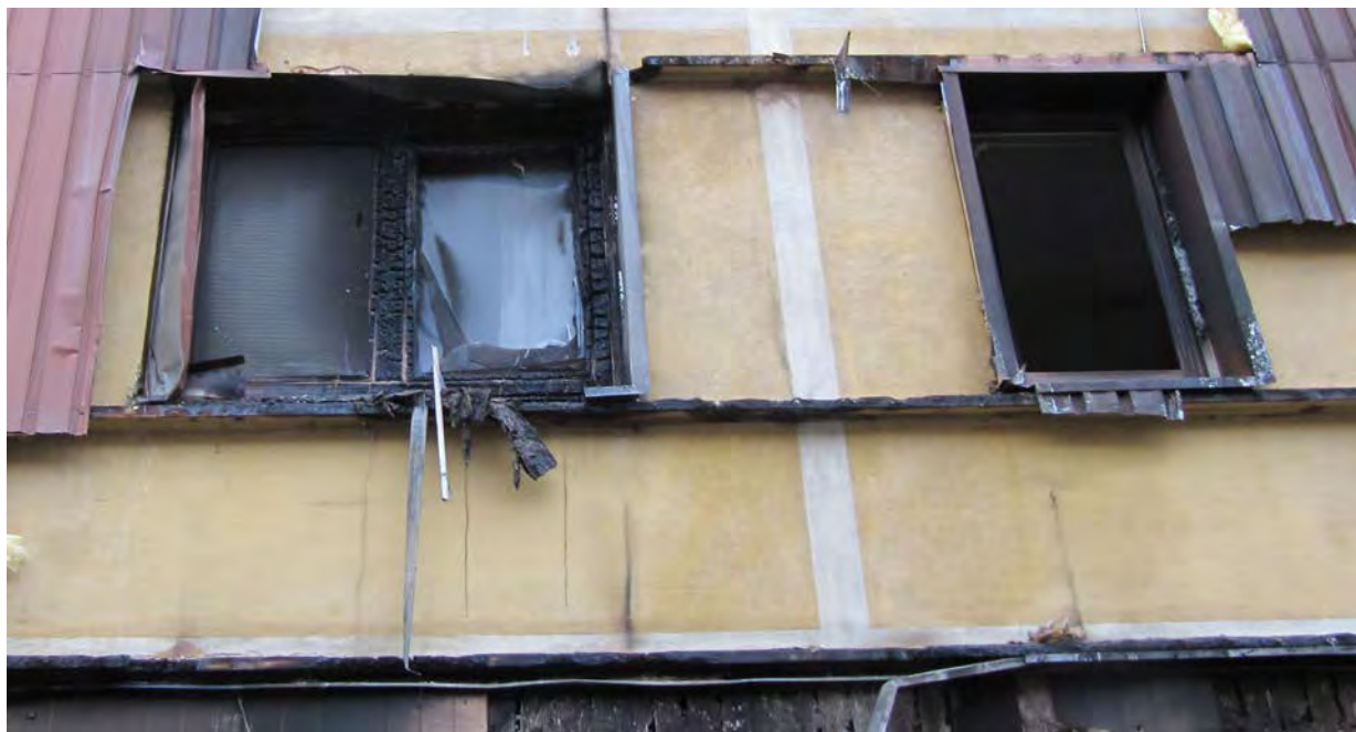
Bild 4: Brandskadat fönster till lägenheten ovanför.
