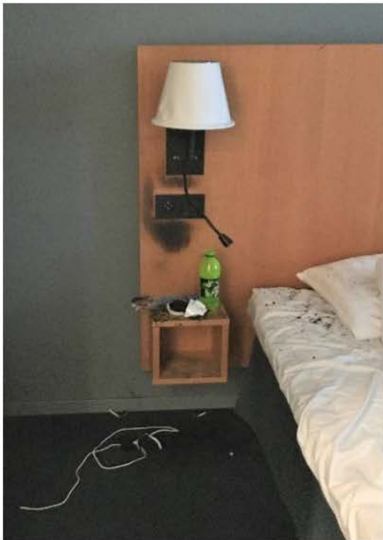
Lampan, väggen och sängbordet har kolat
