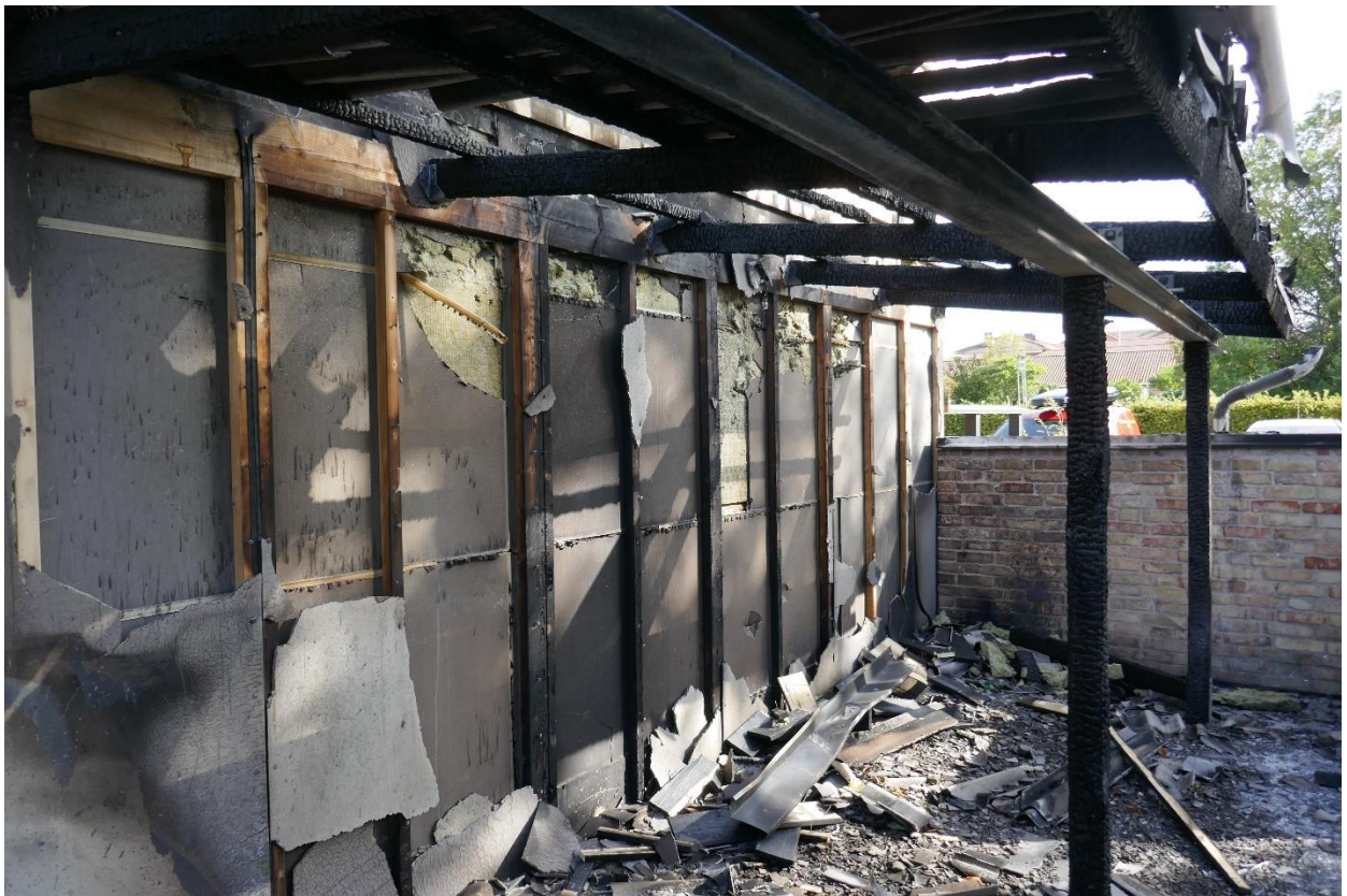
Foto 2. Kraftiga brandskador på skärmtak och träreglar.
