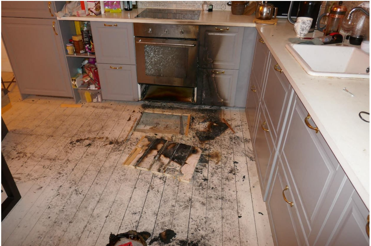
Foto 3. Brand i golv och köksinredning. Brandskadorna på golvet visar spår av brandfarlig vätska som troligen spillts ut i samband med att vätskan i dunken antänts.
