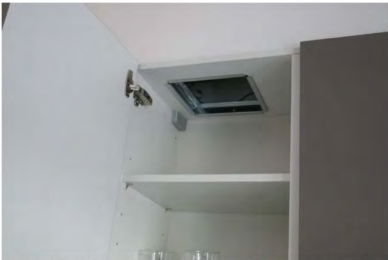
Foto 4. Inspektionslucka ovanför köksskåpen i lägenheten på våning tre. Utrymmet ovanför köksskåpen ska inte ha någon förbindelse med ventilationsschaktet, det ska vara en tät brandcellsgräns i EI 60 mellan utrymmena.
