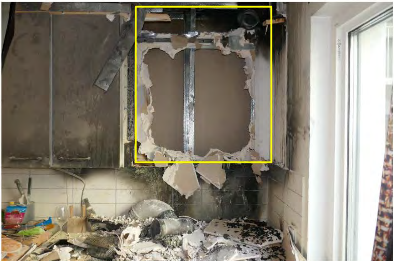
Foto 2. Ventilationsschaktet inom den gula linjen, tre lager gips fanns i brandcellsgränsen.
