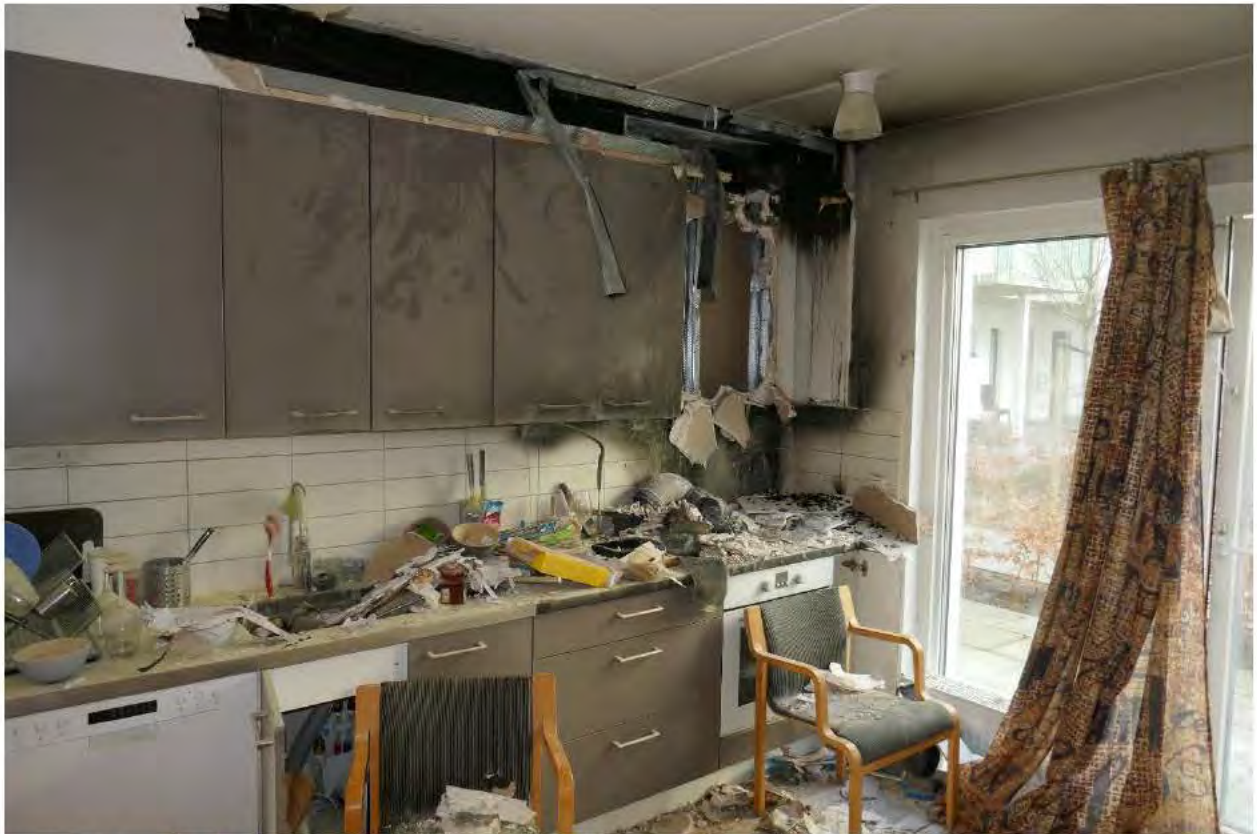
Foto 1. Brand och rivningsskador i köket, ventilationsschaktet i EI 60 ovanför spisen.
