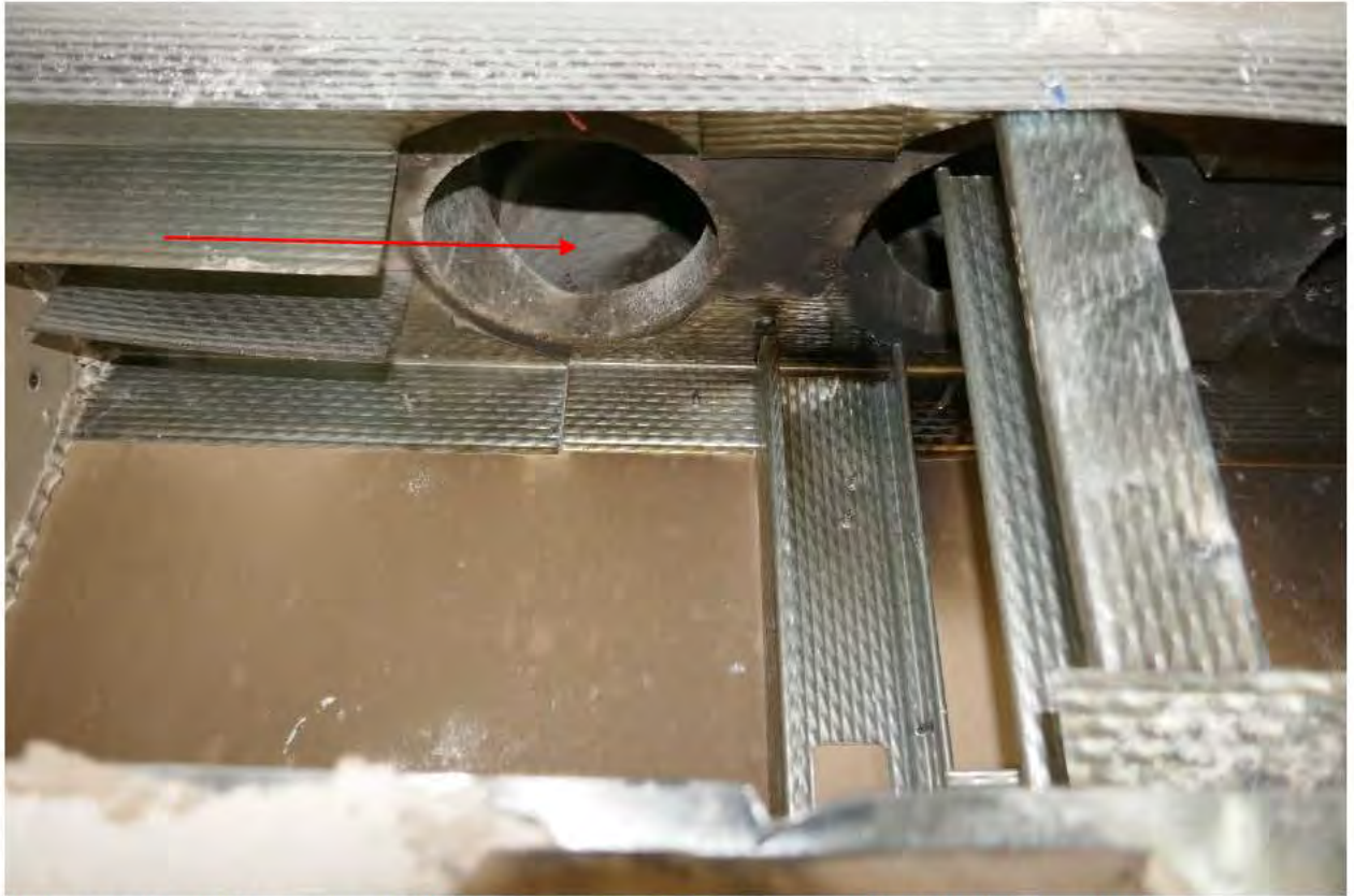
Foto 7. I den vertikala genomföringen syns även den horisontella håligheten vid pilen som går genom betongbjälklaget.
