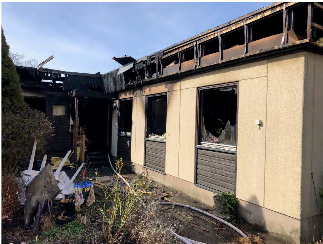
Billd SSBF. Det branddrabbade radhuset och synlig konstruktion för vindarna.
