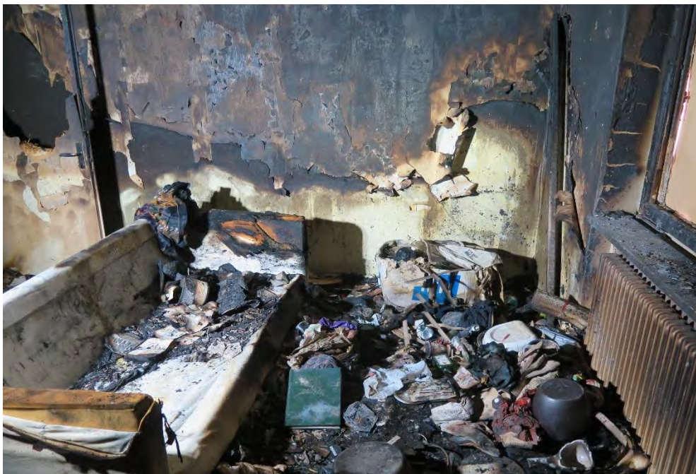
Figur 4. Bild som visar hur golvet såg ut avseende skräp och bråte. Soffan stod vid brandtillfället placerad mot väggen men flyttades under släckningsarbetet.
