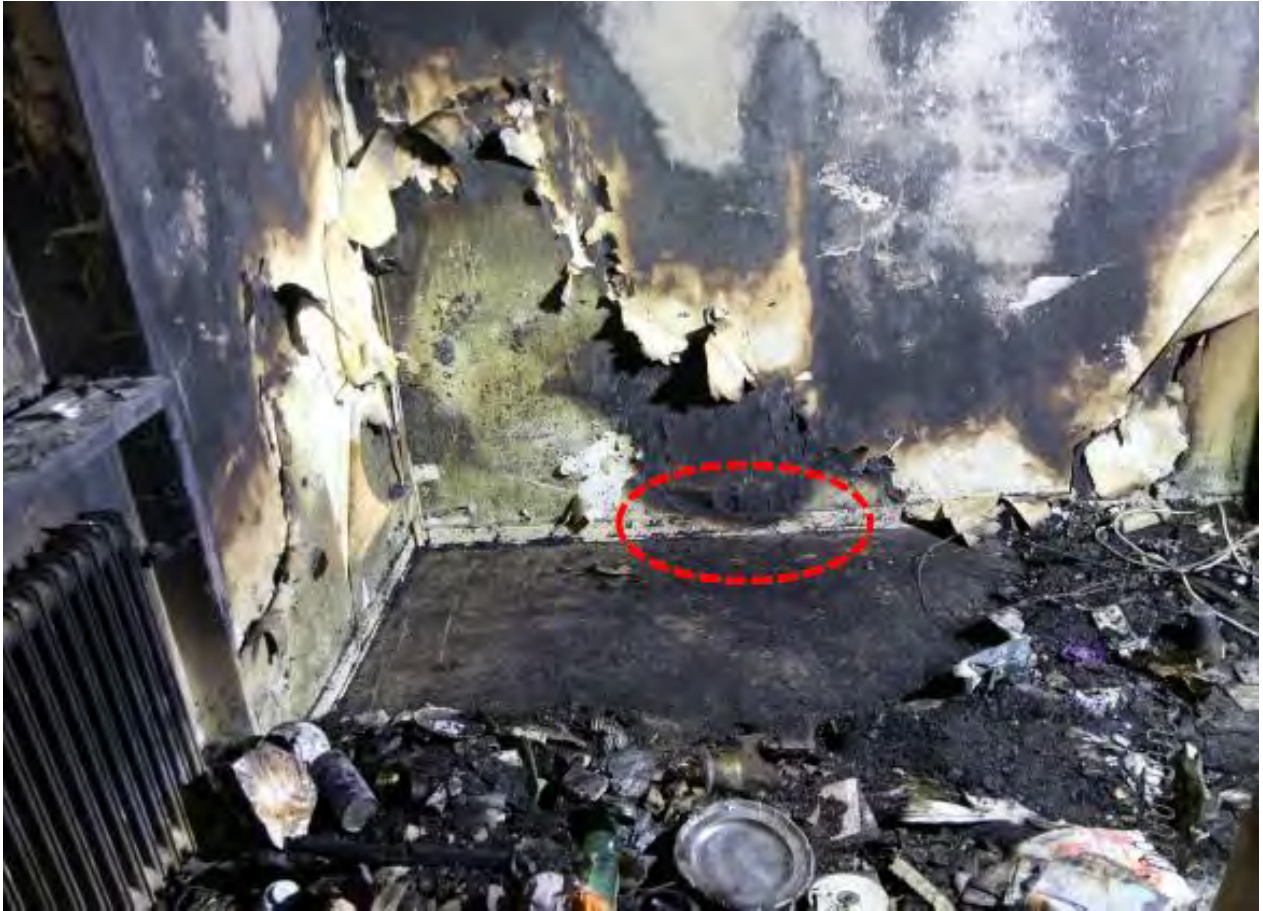
Figur 5. Bild på det låga brandmönstret i högra hörnet. Detta bedöms som det primära brandområdet.
