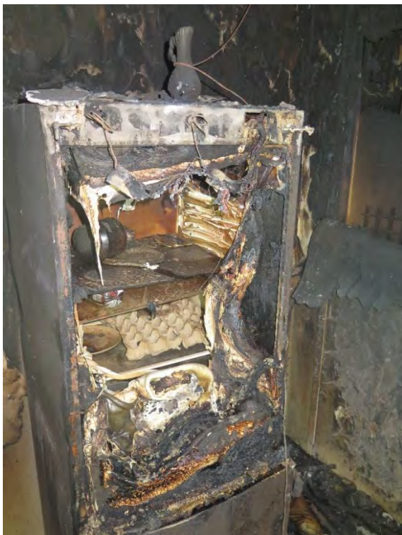
Figur 6. Bild på kyl-och frysskåpet som är totalt brandskadat.
