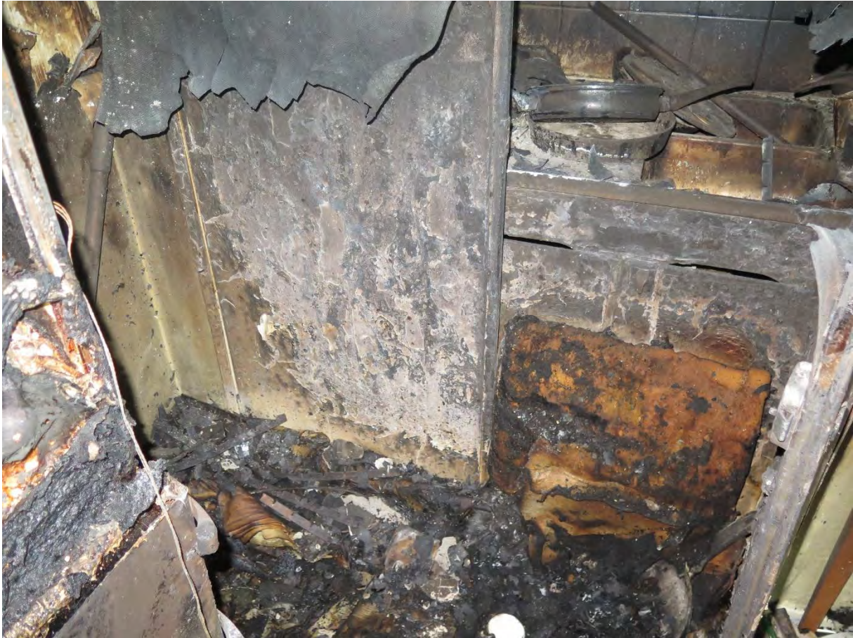
Figur 7. Bild på kokvrån som hade väldigt omfattande brandskador. Dessa bedöms bero på att branden getts syre från ventilationstrumman.
