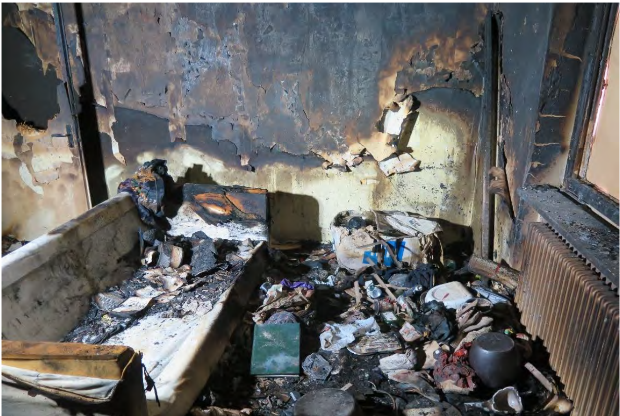
Figur 4. Bild på det vänstra hörnet där soffan stod placerad vid brandtillfället. På golvet syns mängderna med skräp och material.
