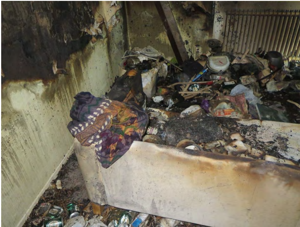
Figur 10. På väggen syns tydligt hur soffan har skyddat den mot brandskador nedtill.
