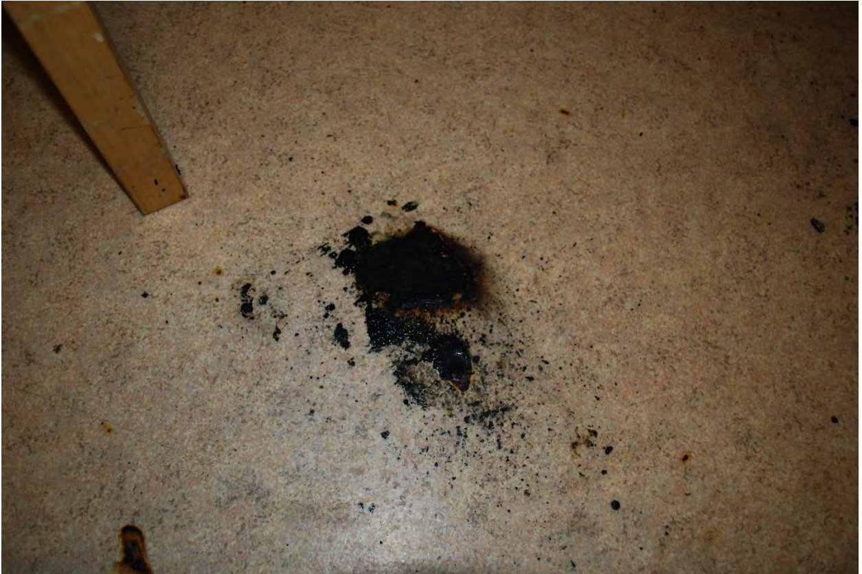
5. Skador på golv även brännskador från tidigare incidenter.
