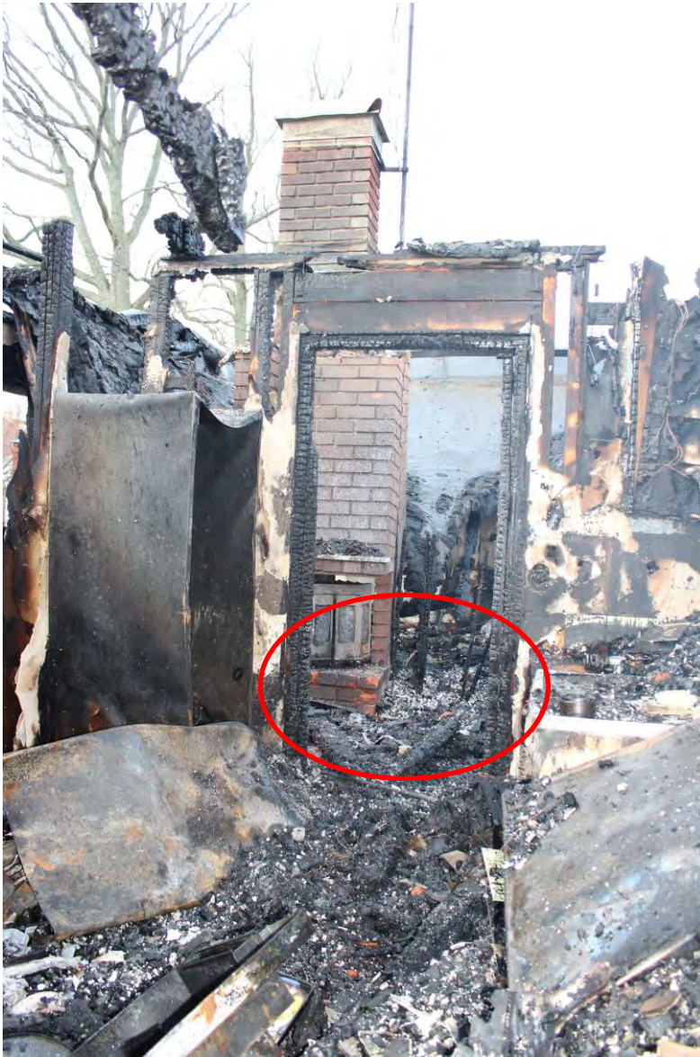
Bild visar delar av vardagsrummet. Den delen av byggnaden där lägst belägna och kraftigast noterade brandskador kunde dokumenteras är markerad med röd ring.
