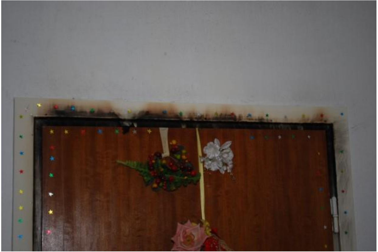
Bild 5. Brand- och sotskador i ovankant på lägenhetsdörren.
