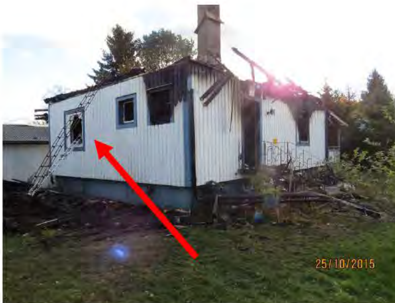
Bild 7: pilen visar den del av villan som klarat branden bäst.
