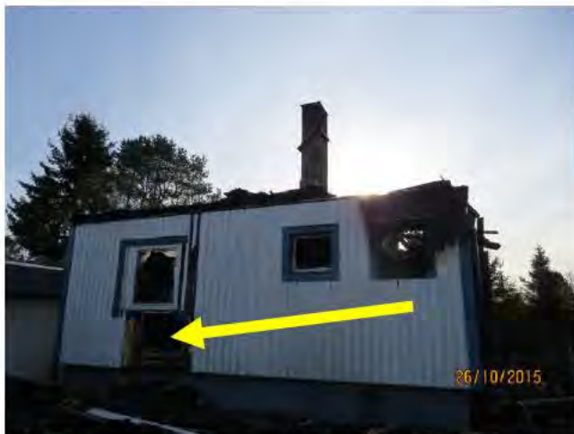
Bild 1: gula pilen visar det hål som gjordes i ytterväggen för att få ut en av personerna.
