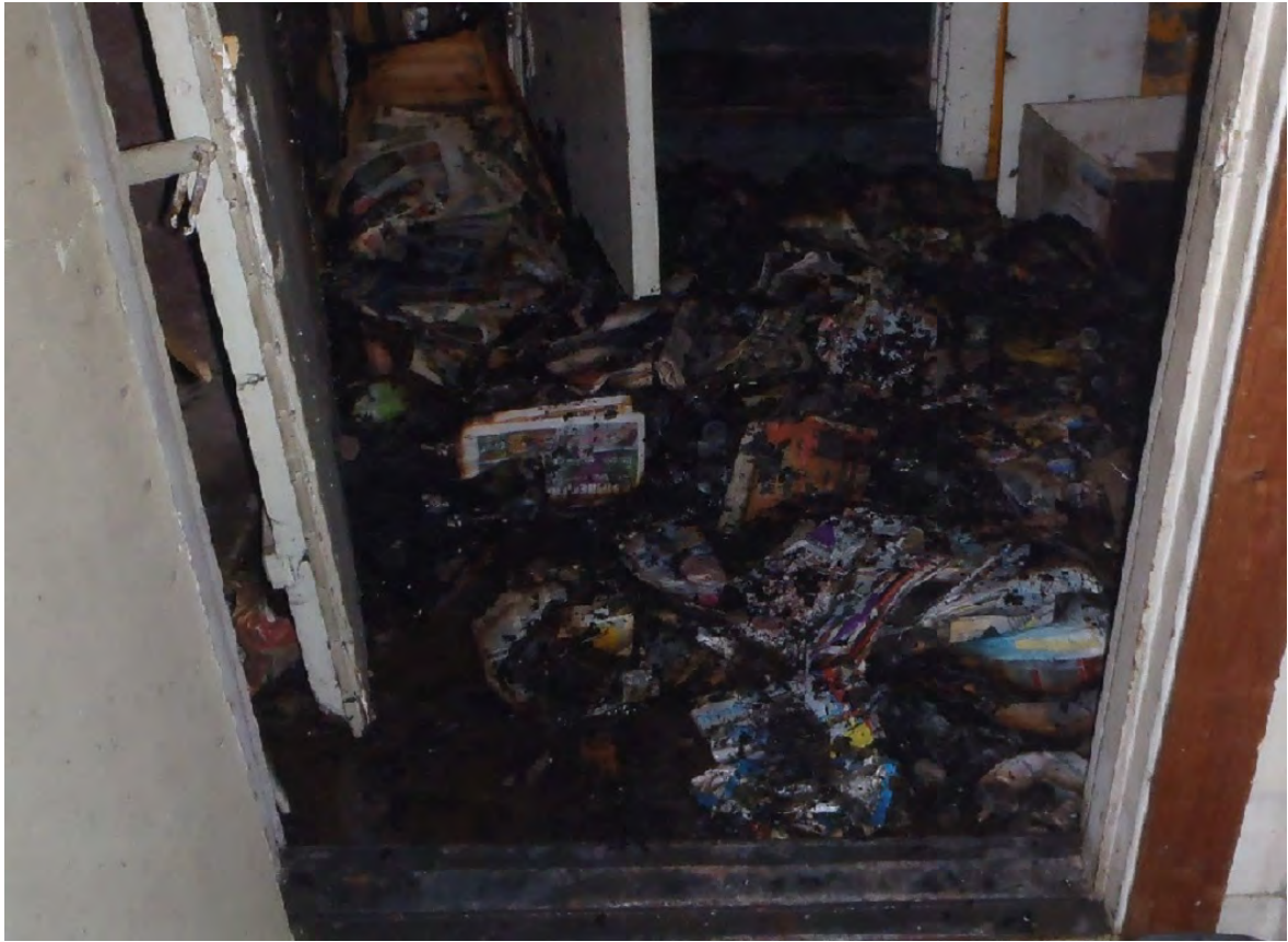
Bild 1: Visar på en större mängd av tidningar i pannrummet.
