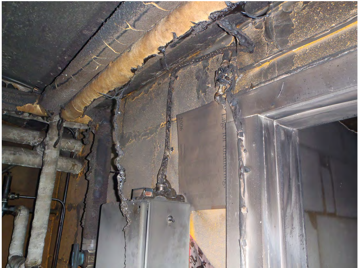
Bild 5: Brandskadad vägg och tak i pannrum.
