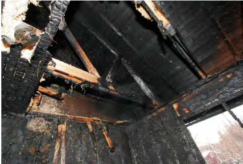
Bild 1. visar rester av vindsbjälklaget ovanför sängen i sovrummet.
