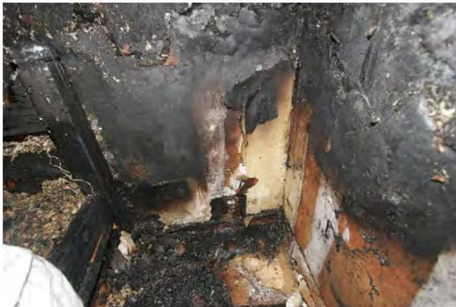
Bild 4. Visar tecken på en låg brand vid sängens huvudända. Det kan tolkas som tecken på primärbrandplatsen.
