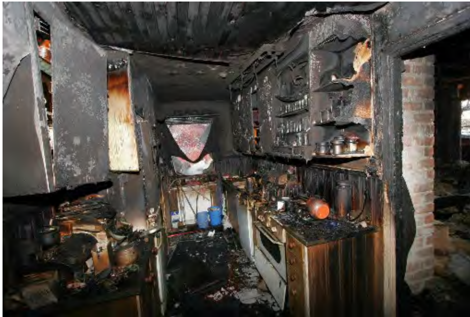
Bild 5. Visar brandskadan i köket. Köket angränsar till sovrummet till höger bakom tegelskorstenen.
