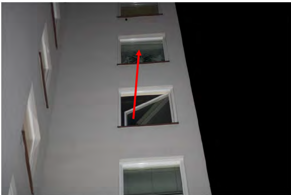
Bild 7. Risk för brandspridning förelåg från köksfönster via motsvarande fönster ovanför.
