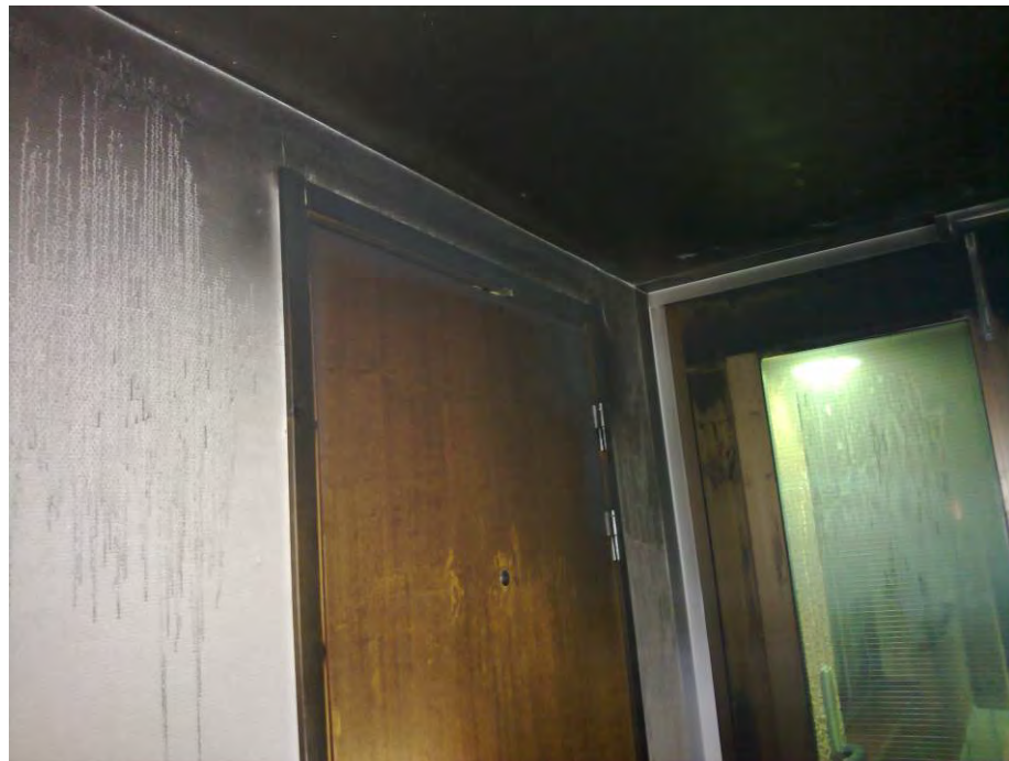
Fig 8: Kraftig nedsooting och värmeskador i korridoren utanför den aktuella lägenheten.
