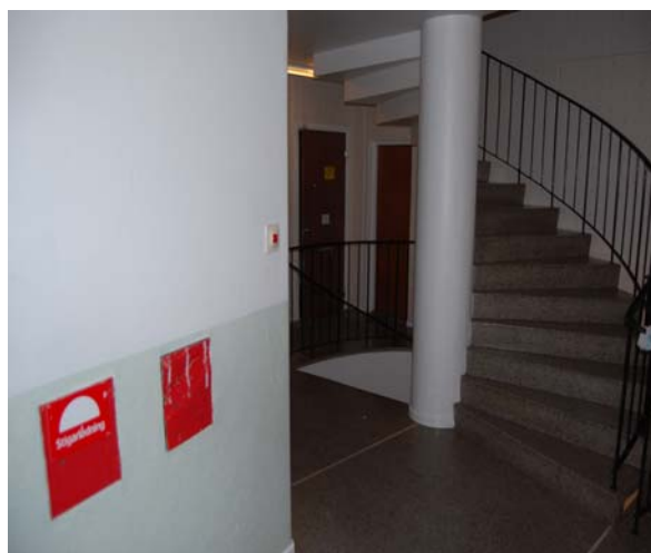
Bild 3. Trapphusets bottenvåning, med manövrering för röklucka innanför entrédörren.
