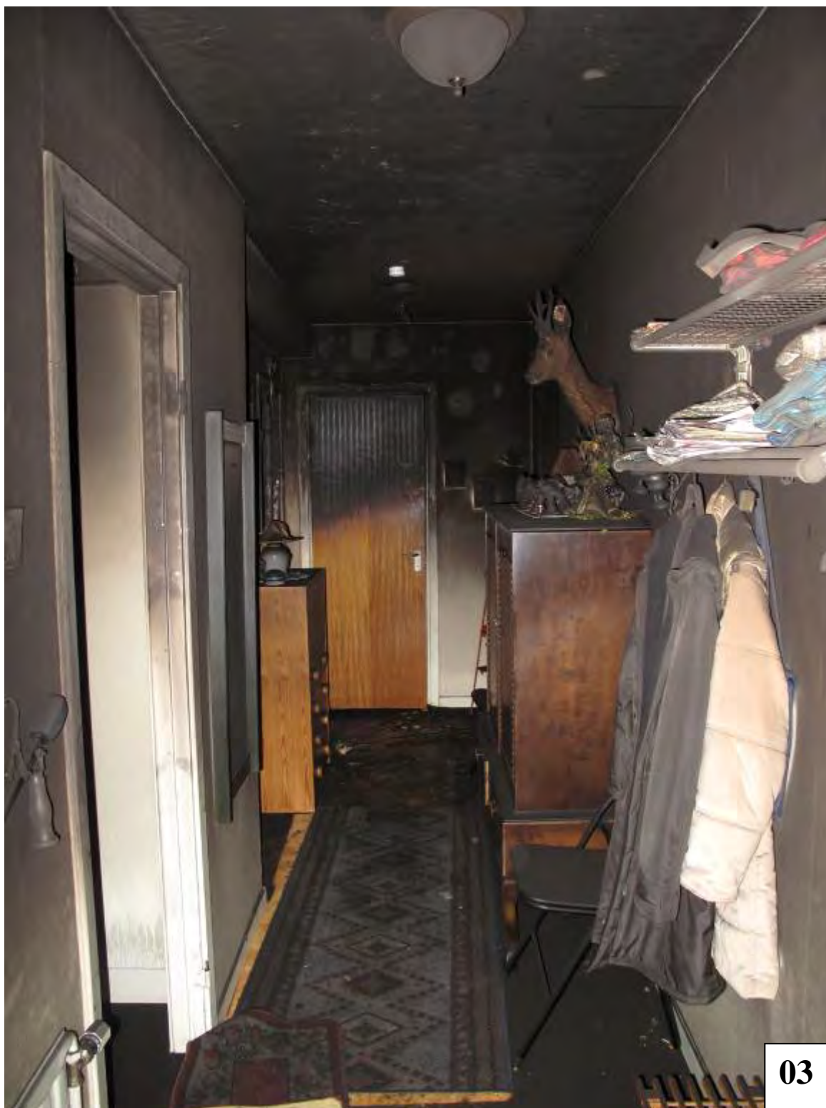
Bilden tagen i hallen, och där är mycket rökskador. Dörr till vänster är köket, dörr bortom byrå vänster är sängkammaren och brandstartrummet. Dörren längst bort är till badrum, rum bortom byrå höger är vardagsrummet.
