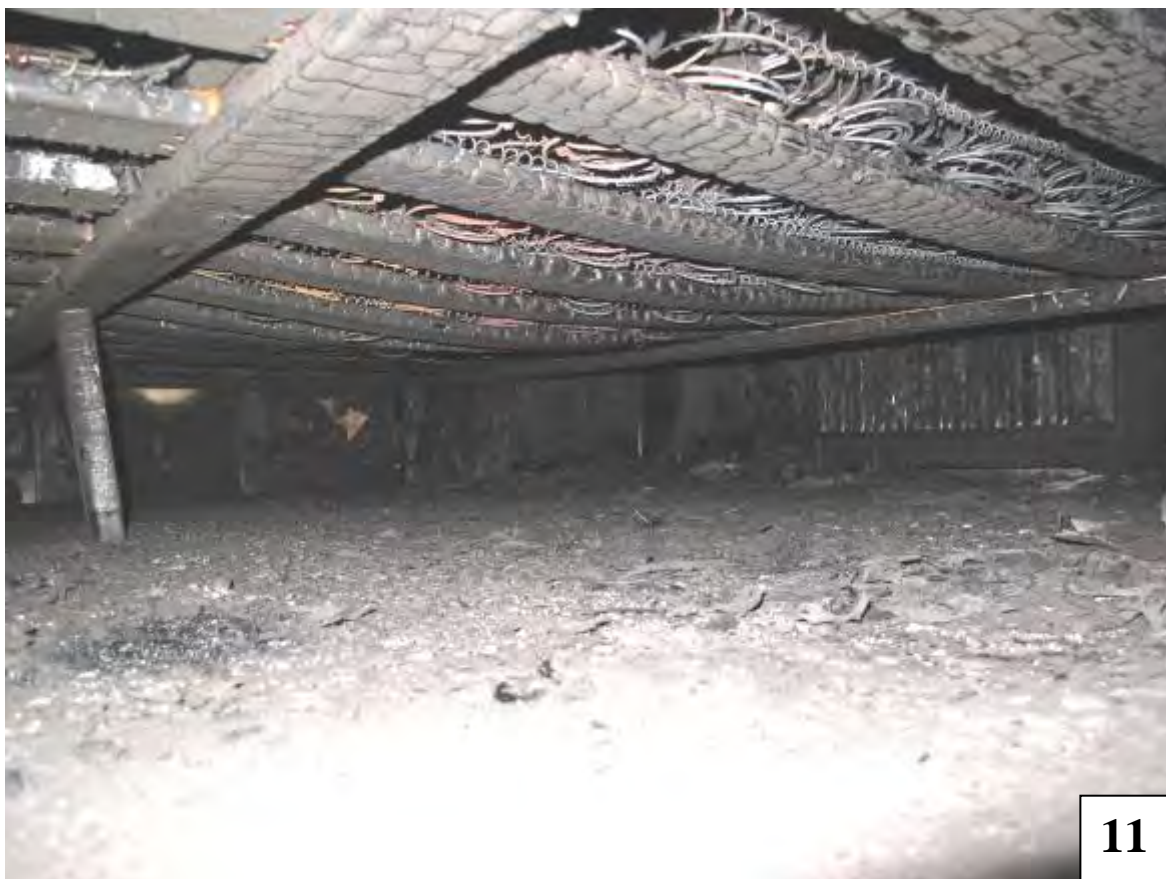
Under sängen där personen som omkommit låg. Sängbotten är bränd underifrån.
