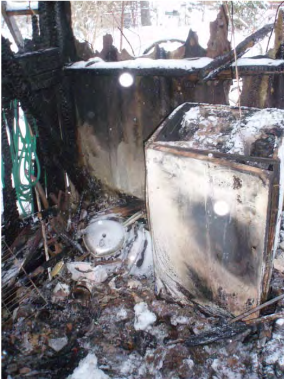
Bild 11: Kylskåpet i förrådet till carporten. Brandpåverkad framsida.
