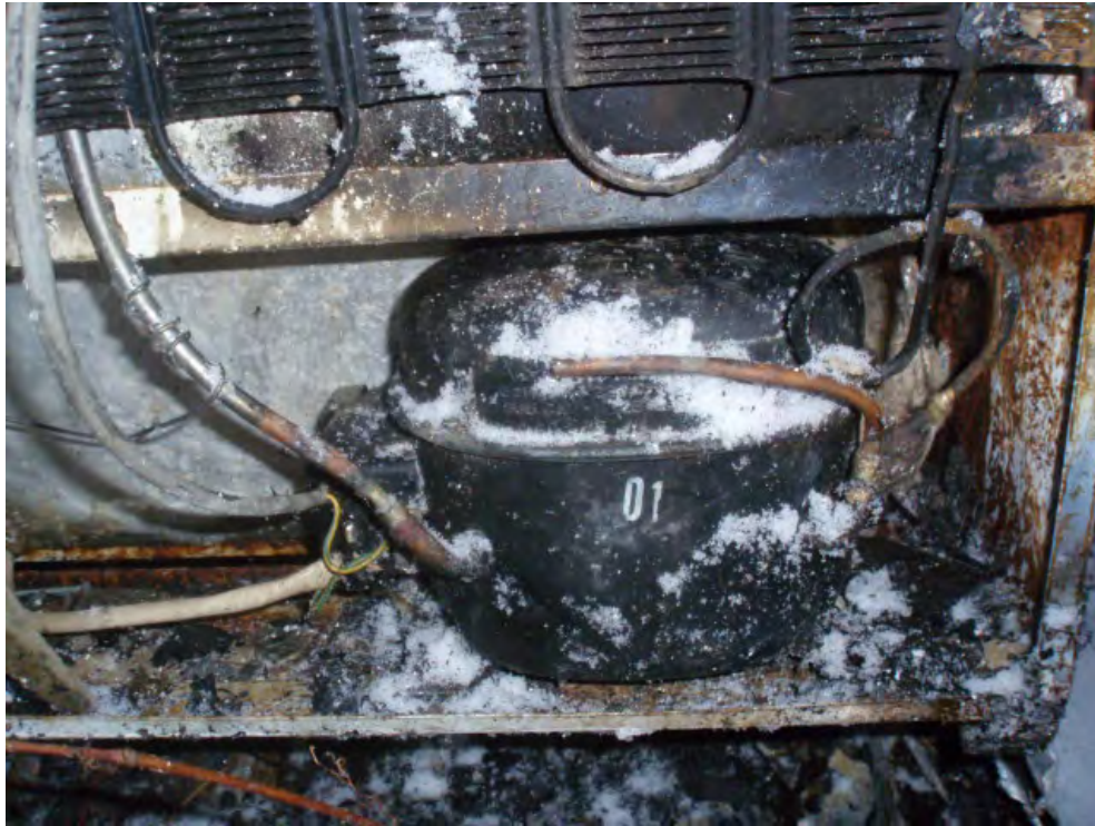
Bild 12: Kylskåpets baksida med startrelä samt kompressor. Inga skador på elledningar m.m.
