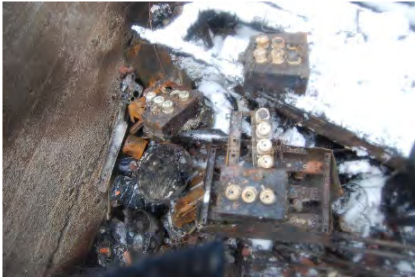
Bild 7. Gruppcentraler som hittades i källaren.
