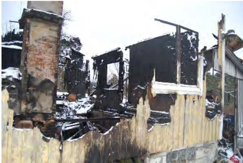
Bild 5. Villan med brandskador.
