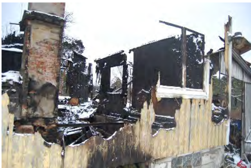
Bild 2. Villan med brandskador
