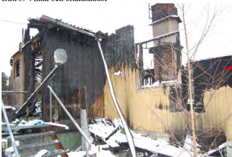
Bild 4. Villan med brandskador
