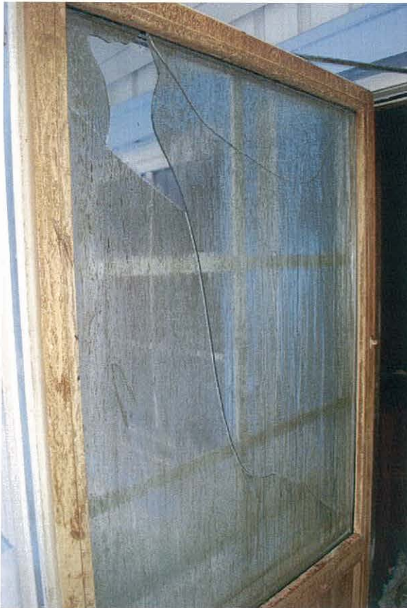
Bild 2: Sotbeläggning och sprickbildning på fönster
