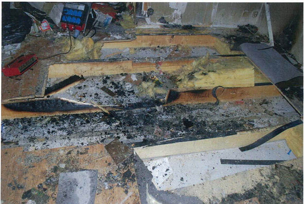
Bild 6: Bild 5: Skador på golvkonstruktionen (träregel)
