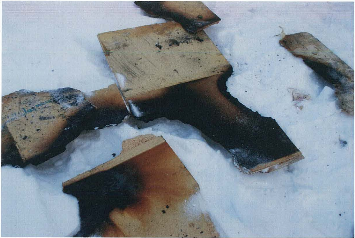
Bild 5: Skador på golvkonstruktionen (spånskiva)
