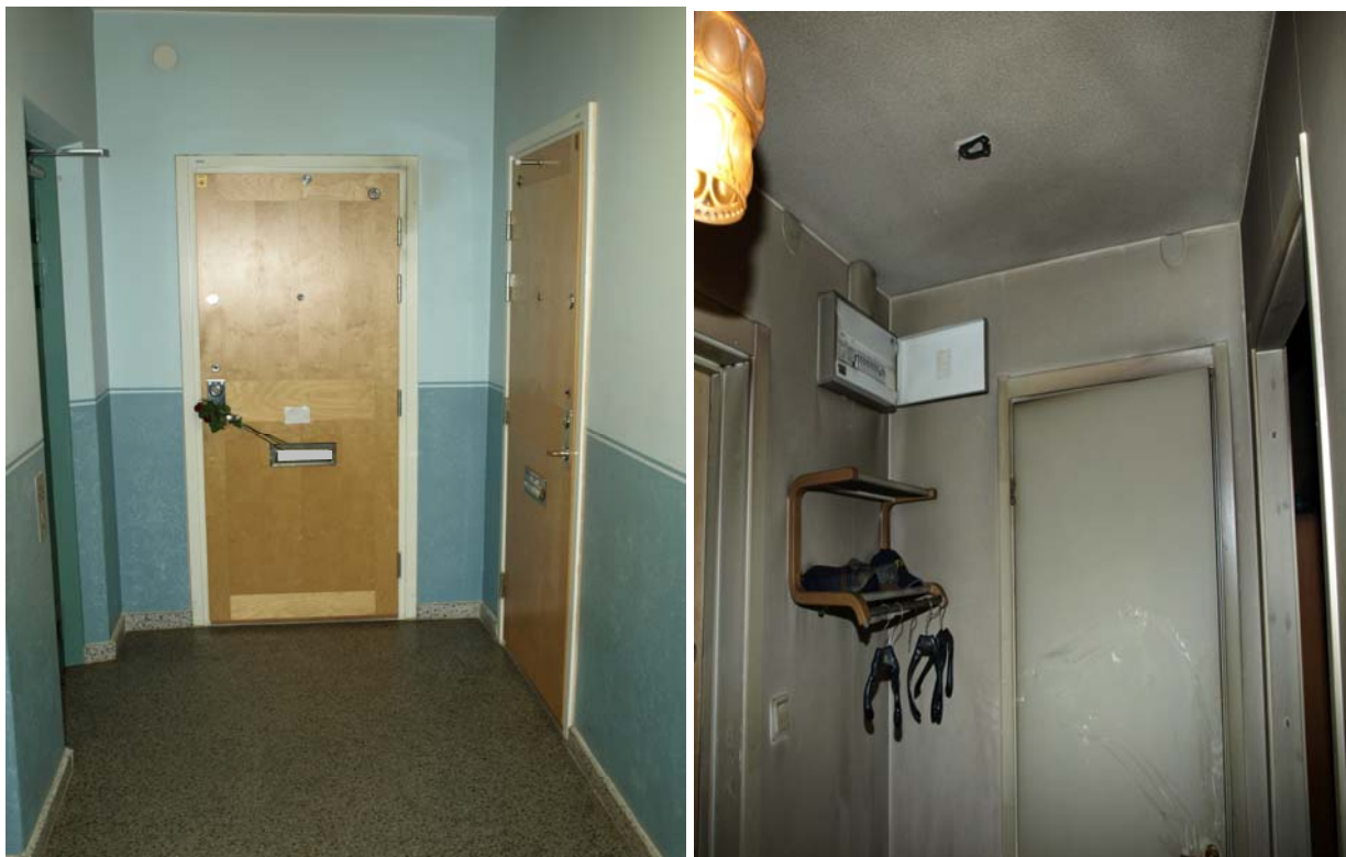
Den brandutsatta lägenhetens dörr. Bilden visar fästet för brandvarnaren i hallen.
