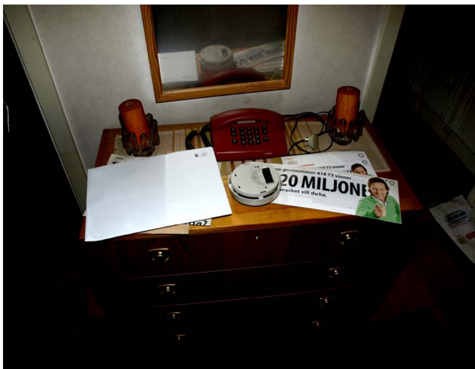
Brandvarnaren nedmonterad, placerad på byrå i hallen.
