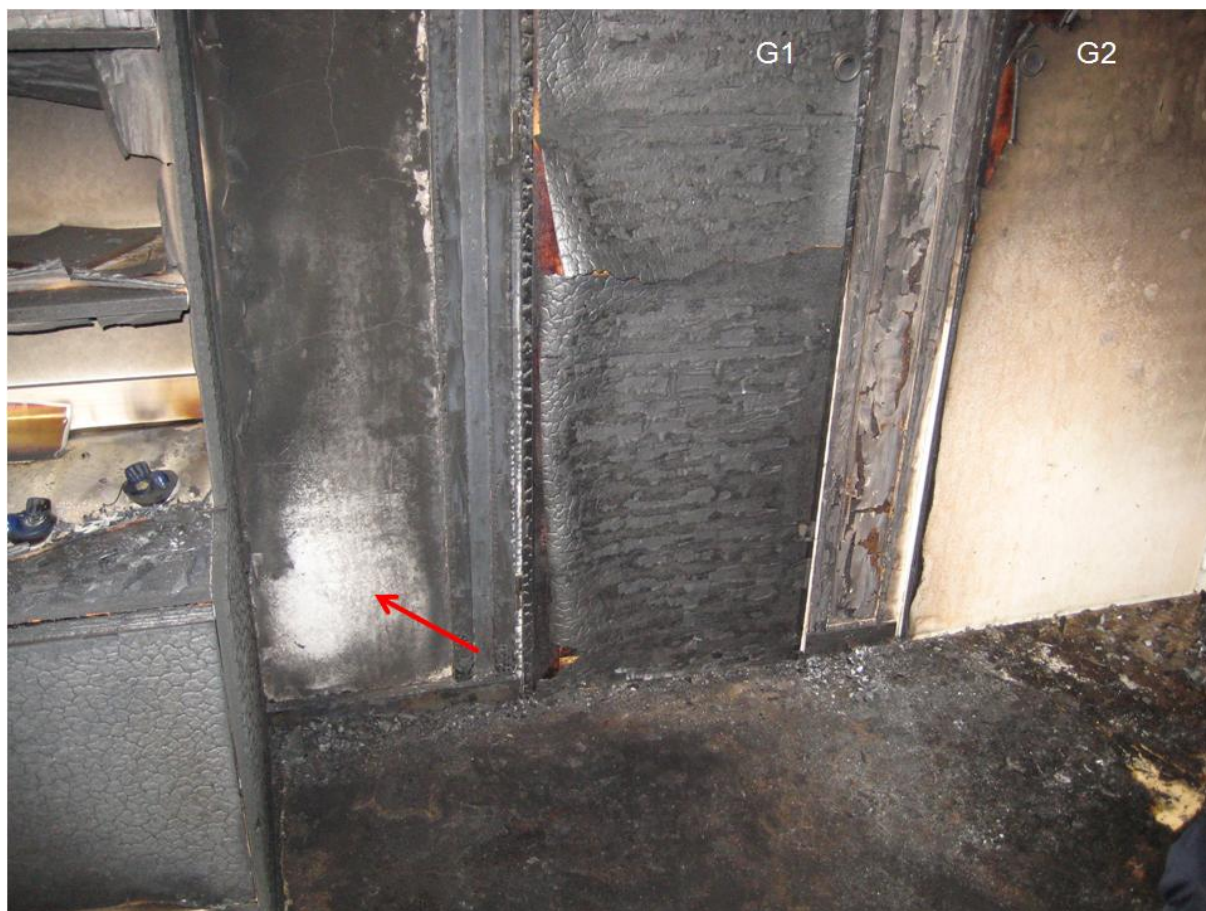
Pilen visar det bortbrända ytskiktet på väggen. Bilden visar även brandpåverkan på de två garderoberna (G1, G2).
