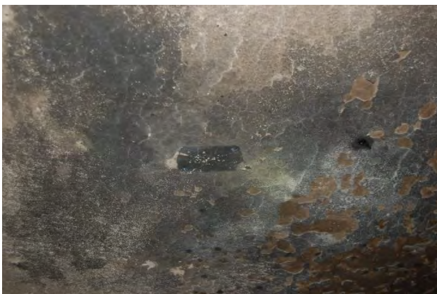
Bild 2 visar spår av eventuell brandvarnare. Källa RSG.
