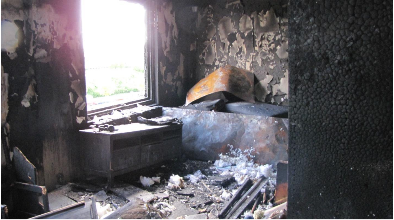
Foto 1. Kraftiga brandskador i lägenheten.
