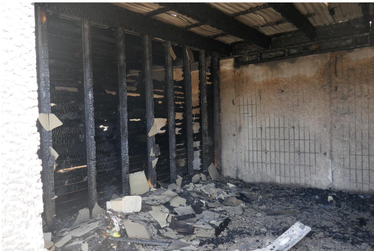
Foto 1. Brandskador på väggar och tak inne i miljöhuset.
