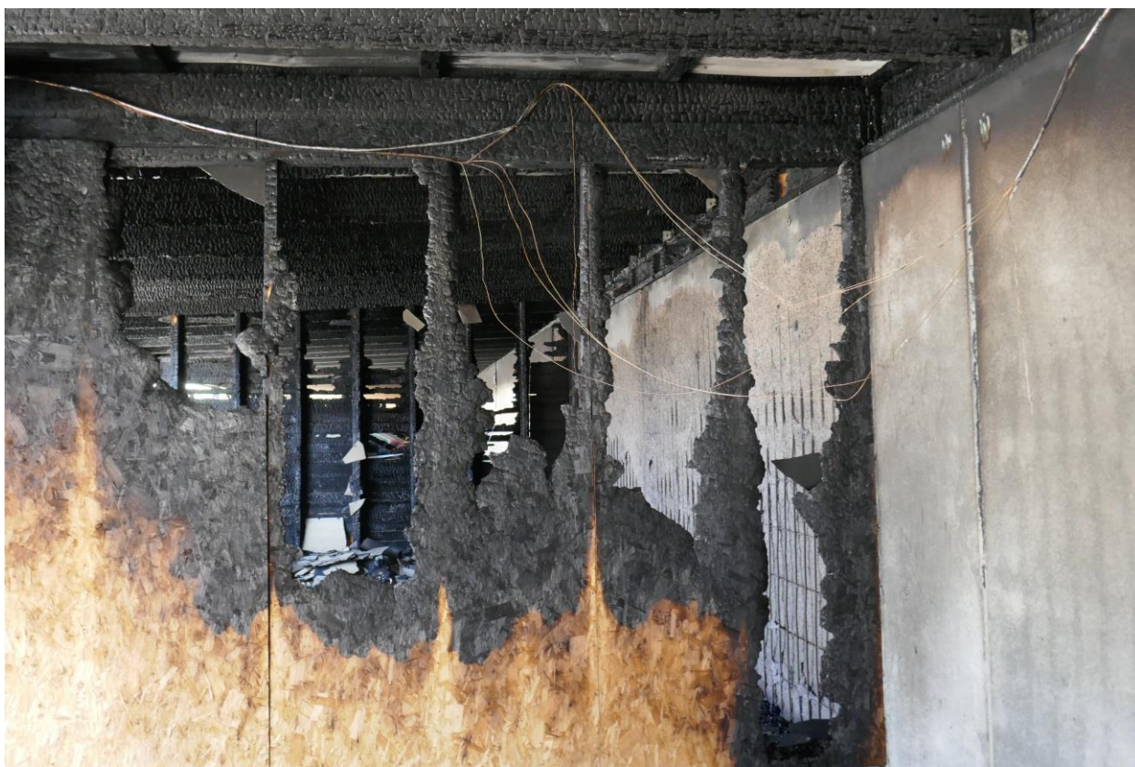
Foto 2. Brandskador på väggar i garaget.
