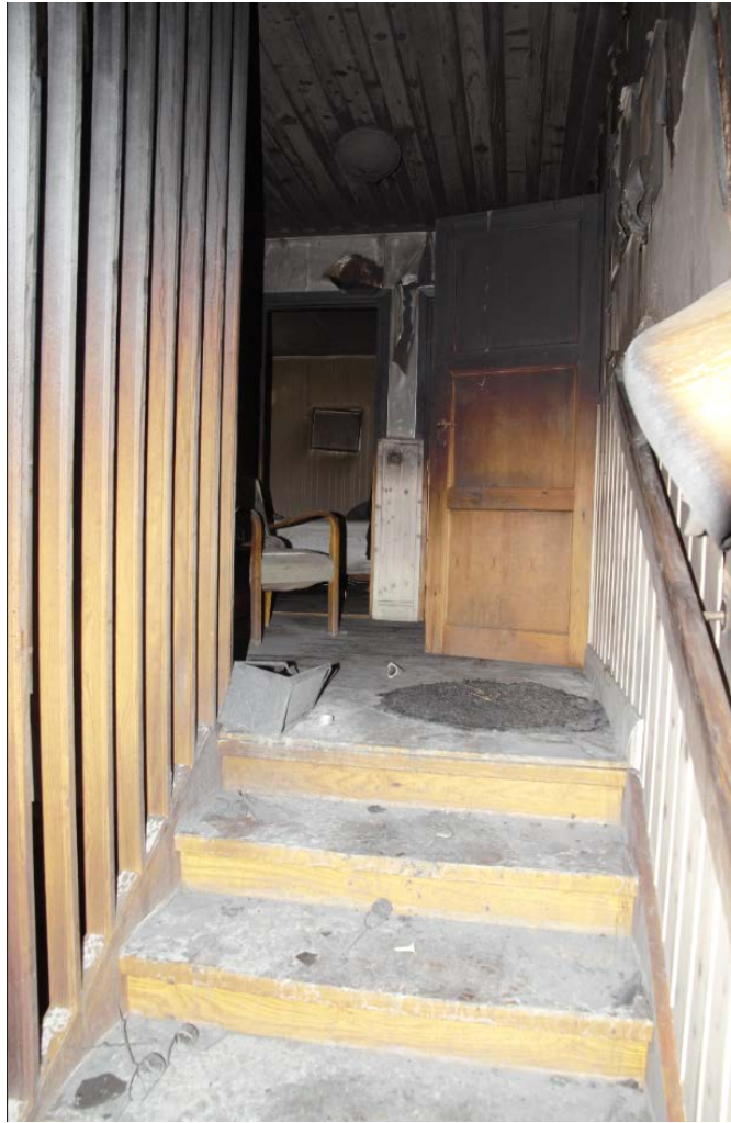
Hela huset blev rök- och sotskadat.
