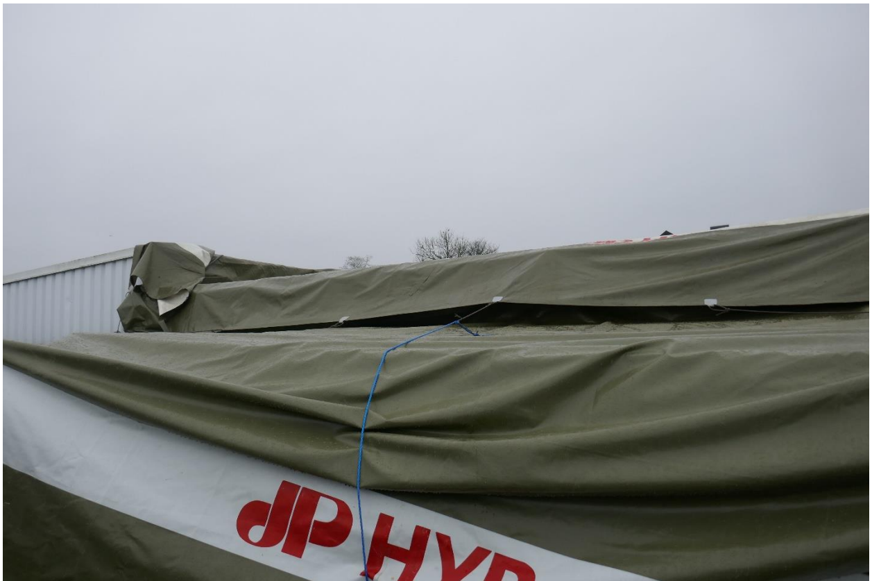
Foto 4. Presenning över det brandskadade taket på 22A.
