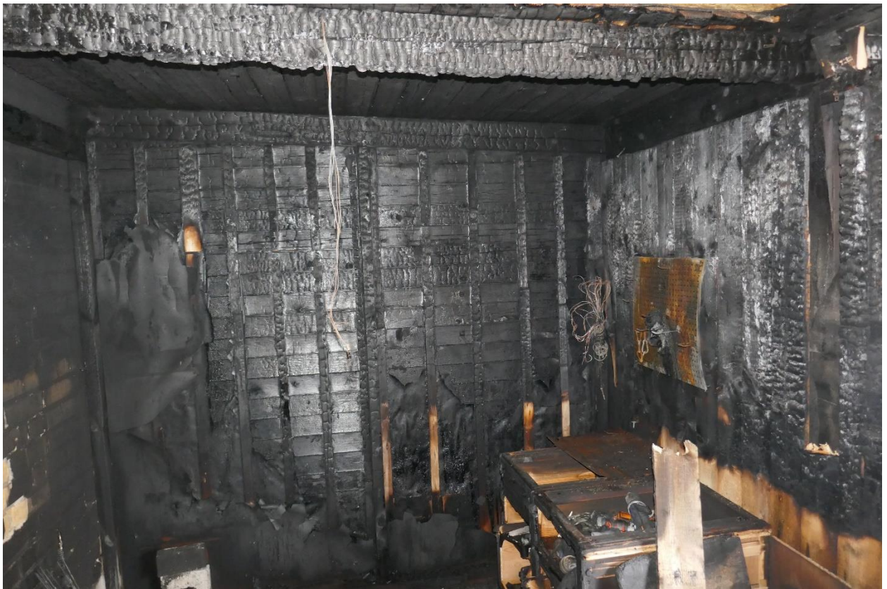
Foto 2. Invändiga brandskador på förrådet.
