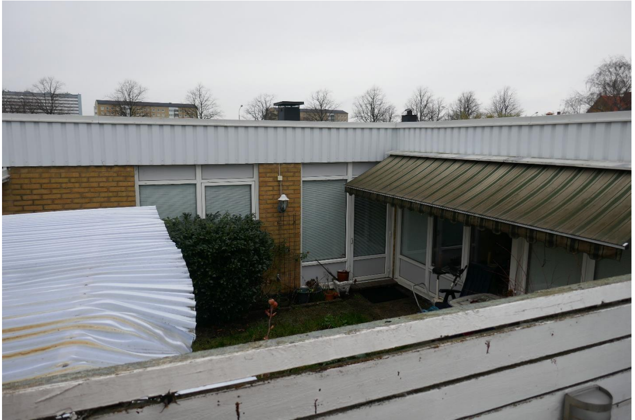
Foto 5. Taket till uteplats på fastigheten [redacted] 20B fick smältskador.
