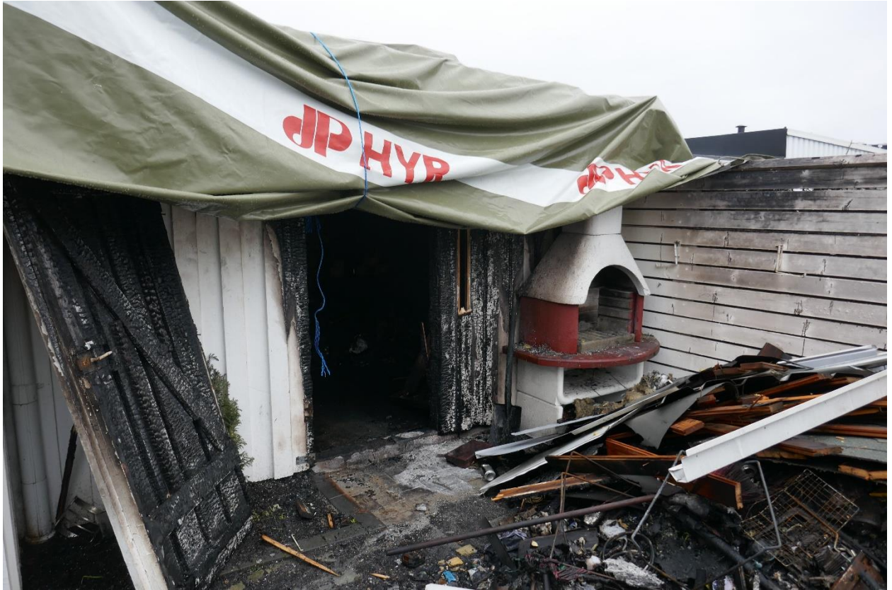
Foto 1. Utvändiga brandskador på förrådet.
