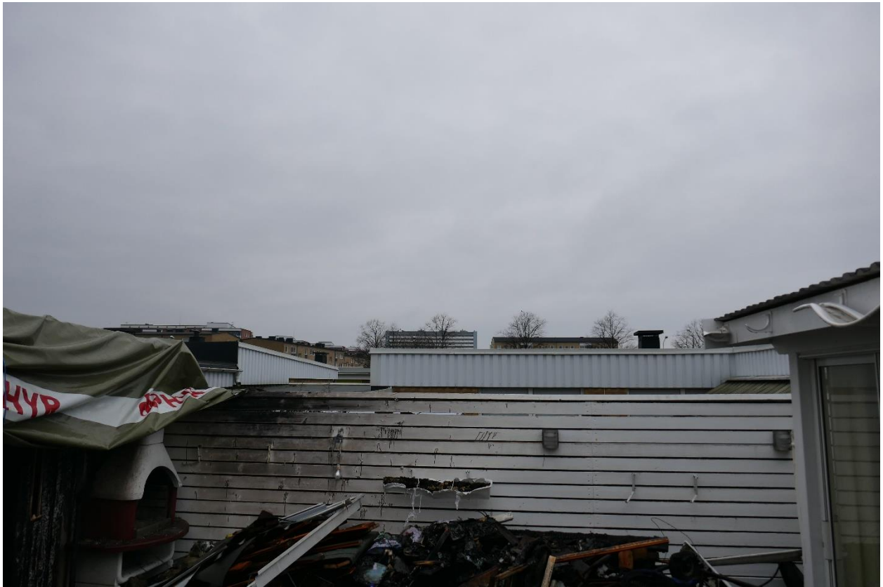
Foto 3. Brandskador på planket mellan byggnaderna 22B och 22A.
