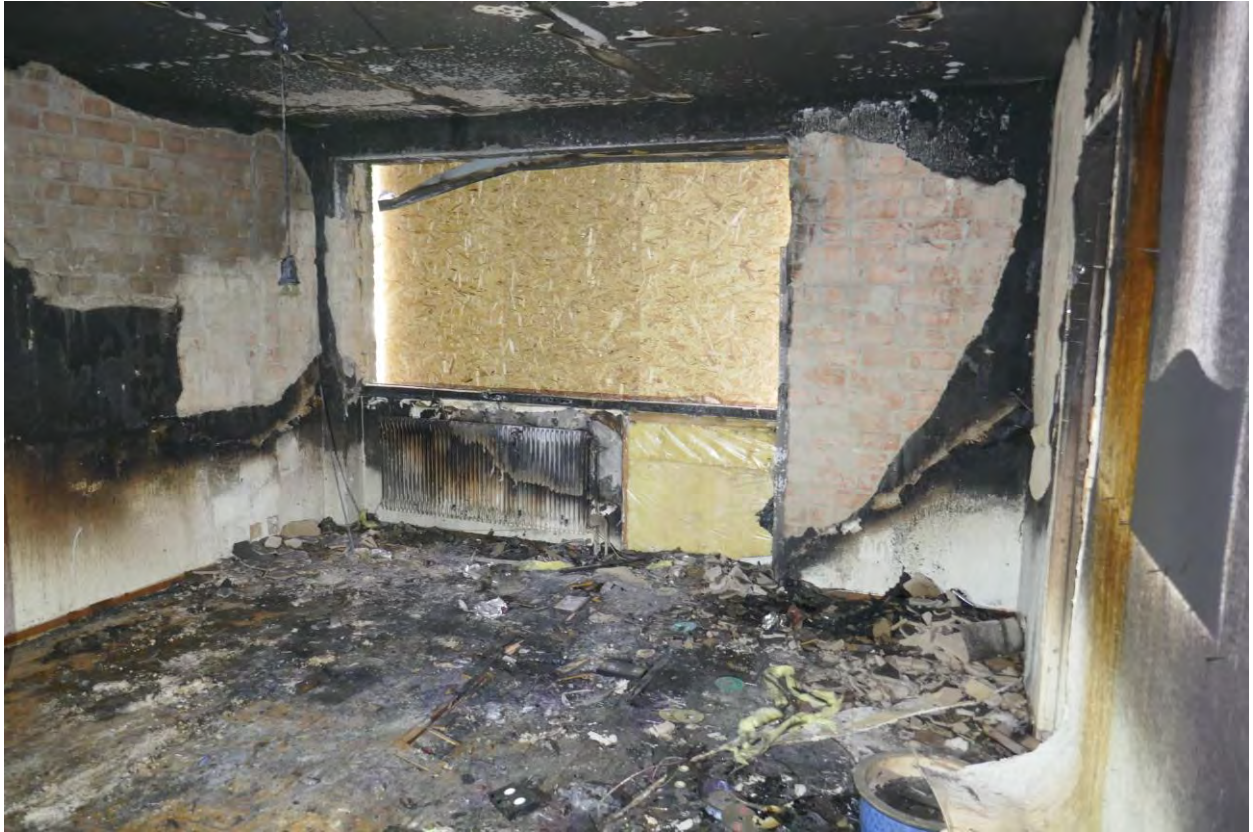
Foto 1. Kraftiga brandskador i vardagsrummet. Förspikat fönster ut mot innergården.
