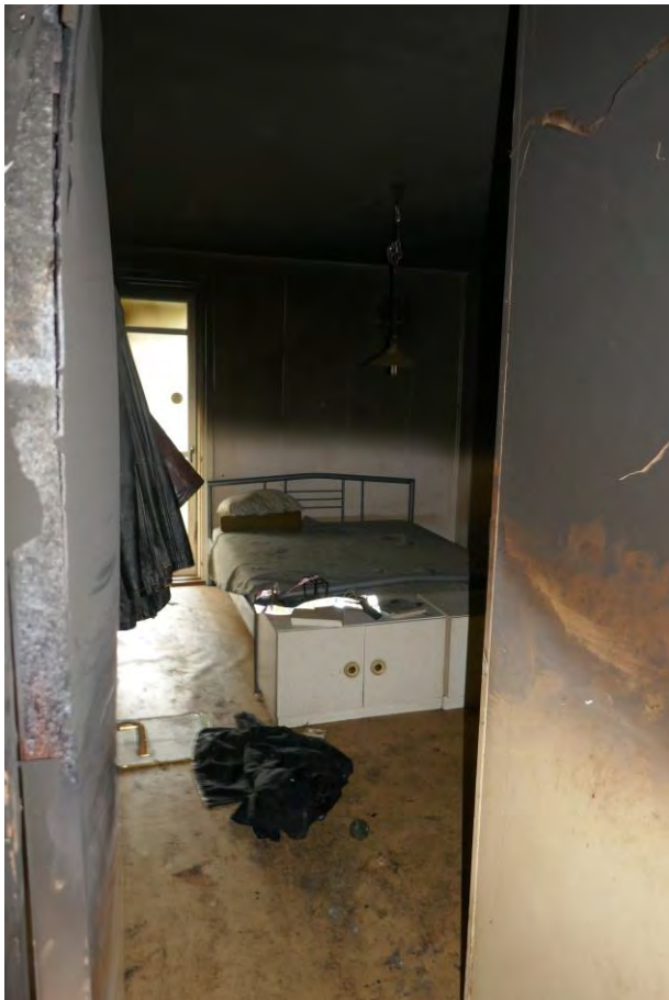
Foto 3. Rök- och sotskador på väggar och tak i sovrummet som angränsar till vardagsrummet.
