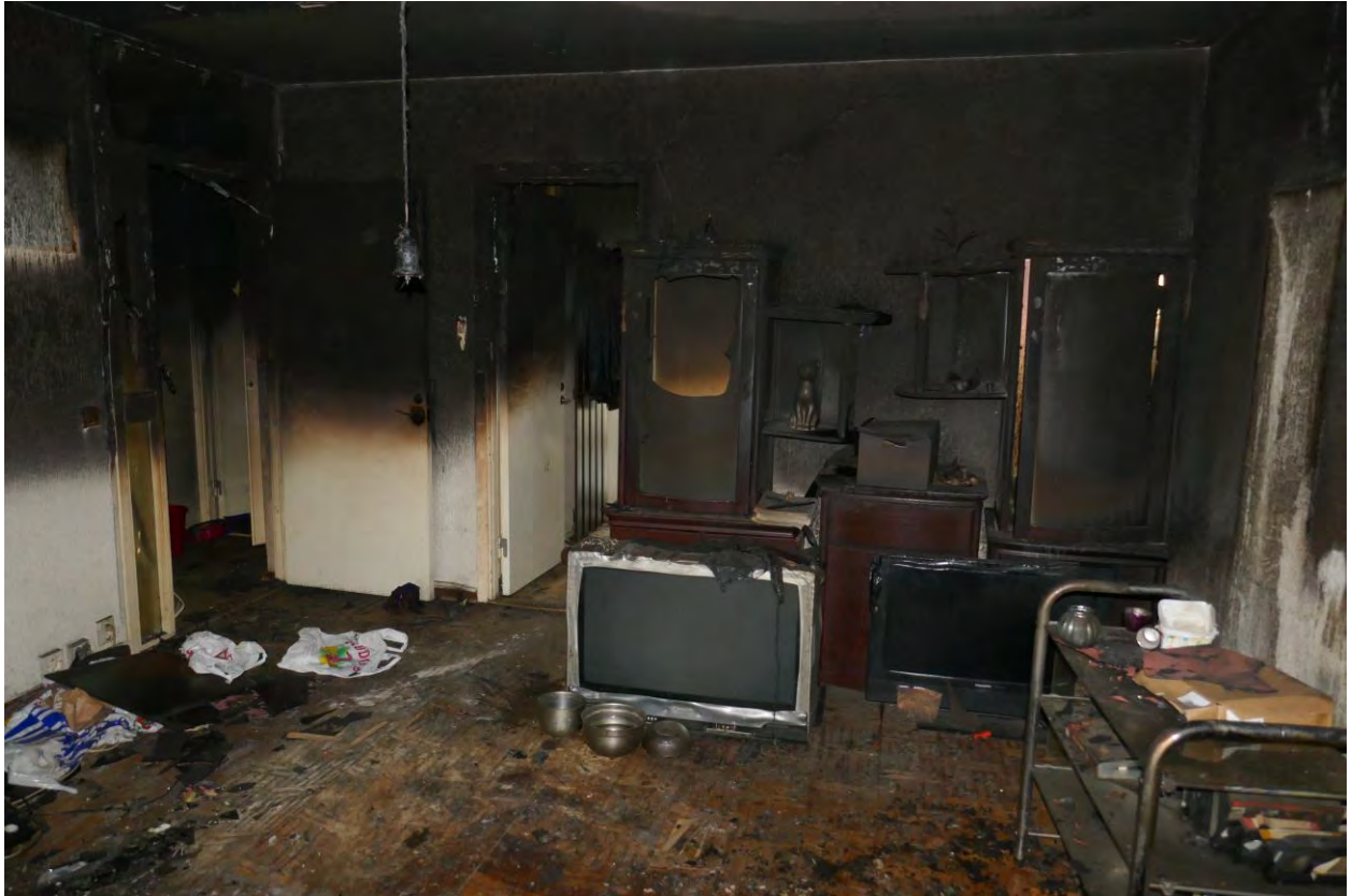
Foto 2. Brandskador på väggar och möbler mot väggen till sovrummet.
