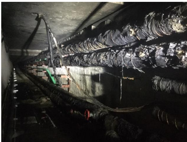
Bild 3 sot- och brandskador i kulvert
