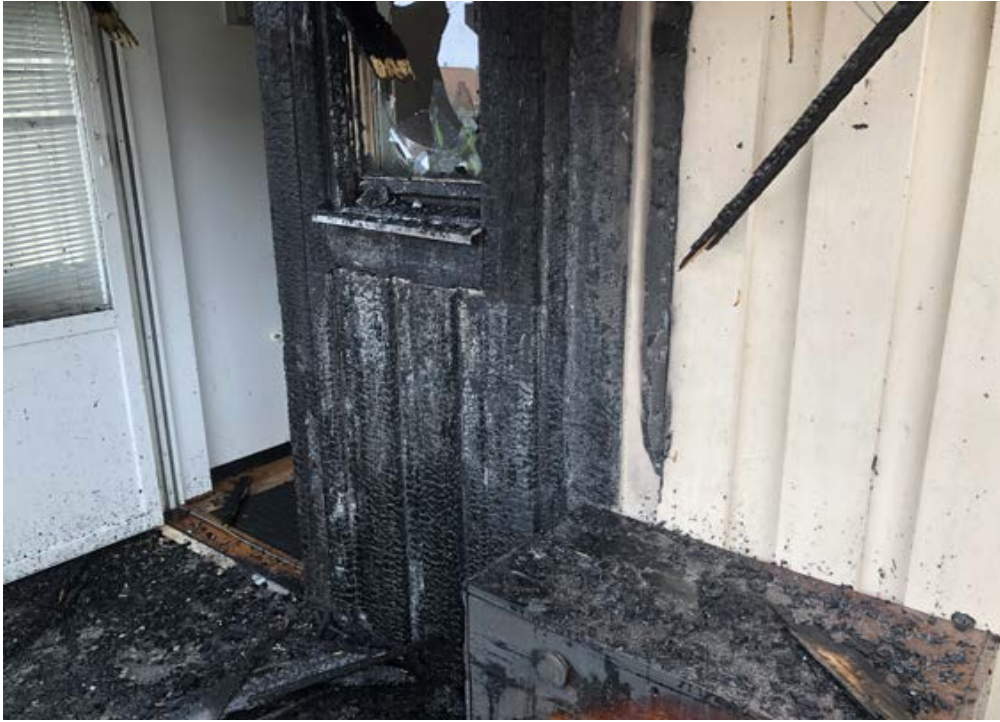
Bild 11. Spridning från kartong och fåtölj via panelen till takfot.
