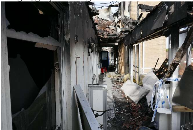
Foto 1. Foto tagits från den branddrabbade lägenheten, taket över loftgången mot vinden som är bortbränt.
