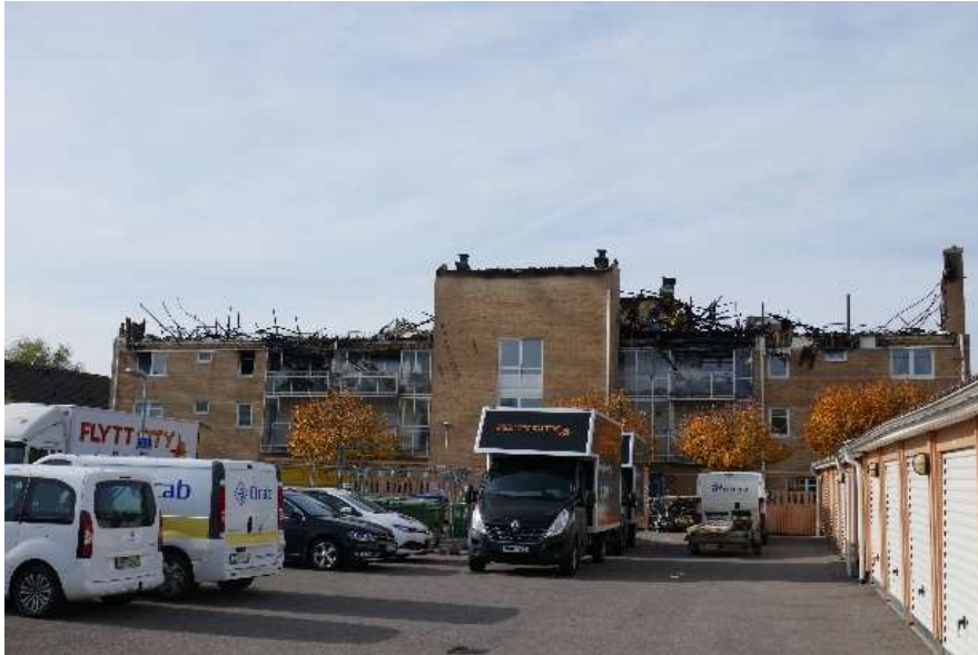
Foto 2. Taket på fastigheten som är bortbränt
