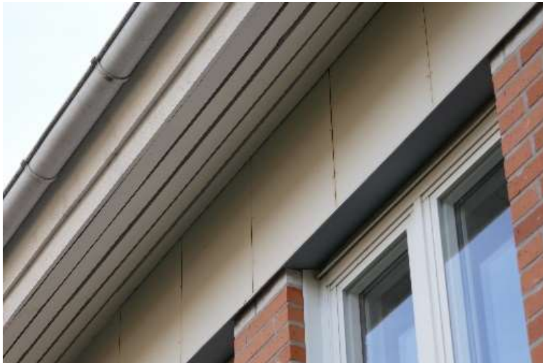
Foto 7. Takfot från byggnaden intill med en brännbar luftad takfot
