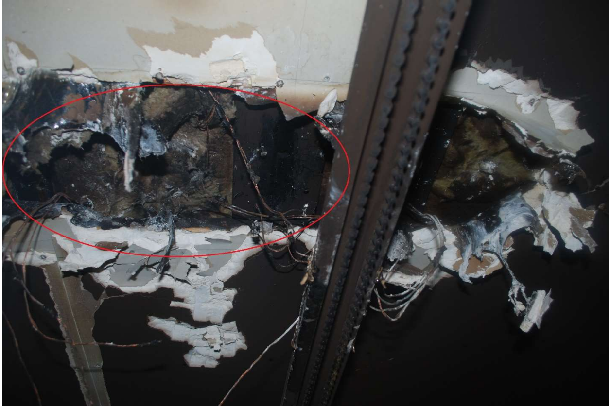
Foto 3. Taket där lysrör och utanpåliggande kopplingsdosa suttit.
