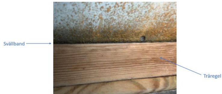
Bild 5 - Svällist på träregel i fasades underkant
