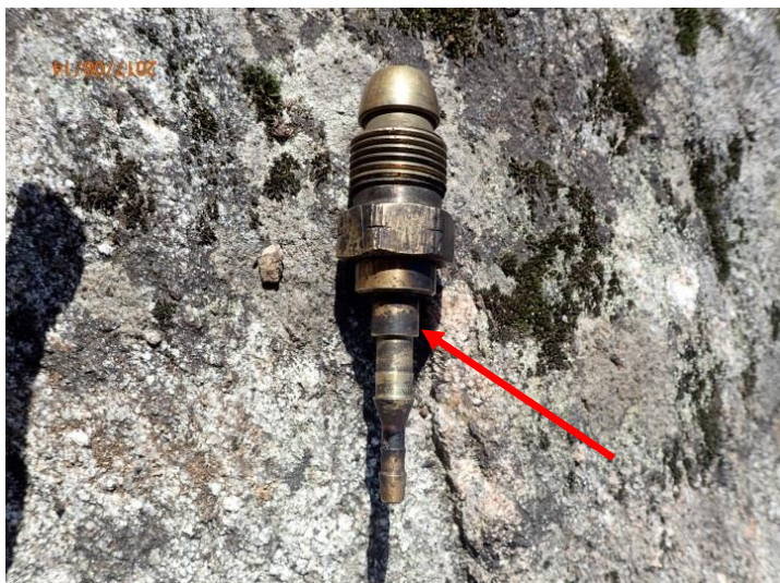
Bild 2: Flaskanslutning med slangbrottsventil. Pilen visar var ventilen läckte vid prov efter tillbudet
